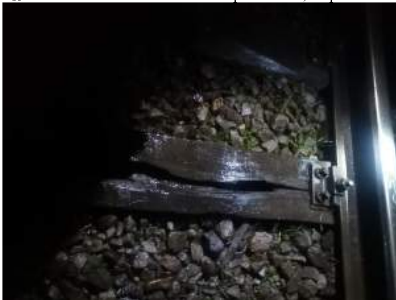
Foto nr. 12- Starea tehnică a traversei T-29
