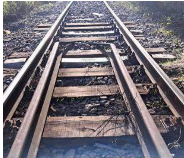
Foto nr.31 – lipsă prindere pe fiecare traversă
