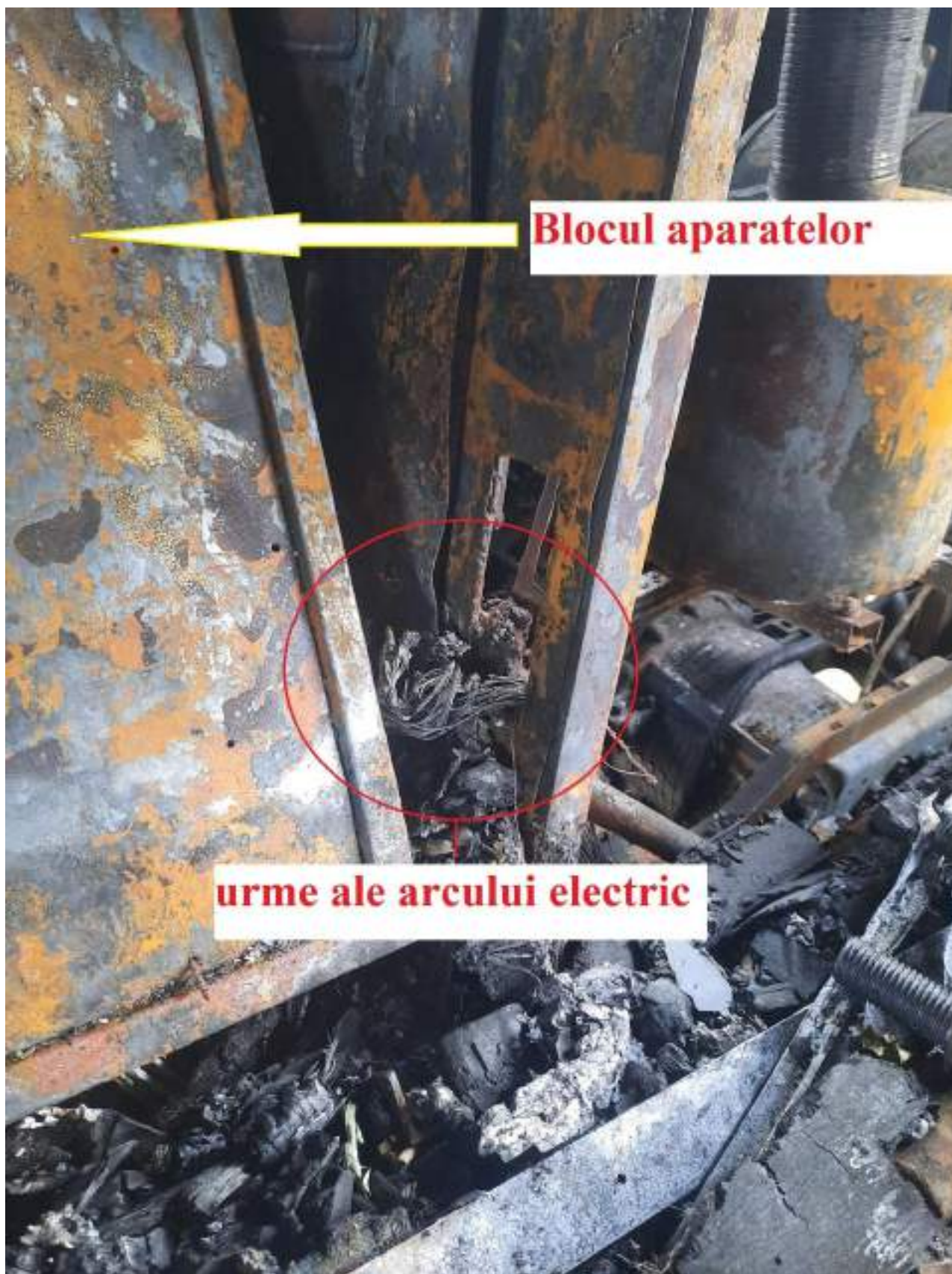
Figura nr.2 – blocul aparatelor (vedere din lateral)
