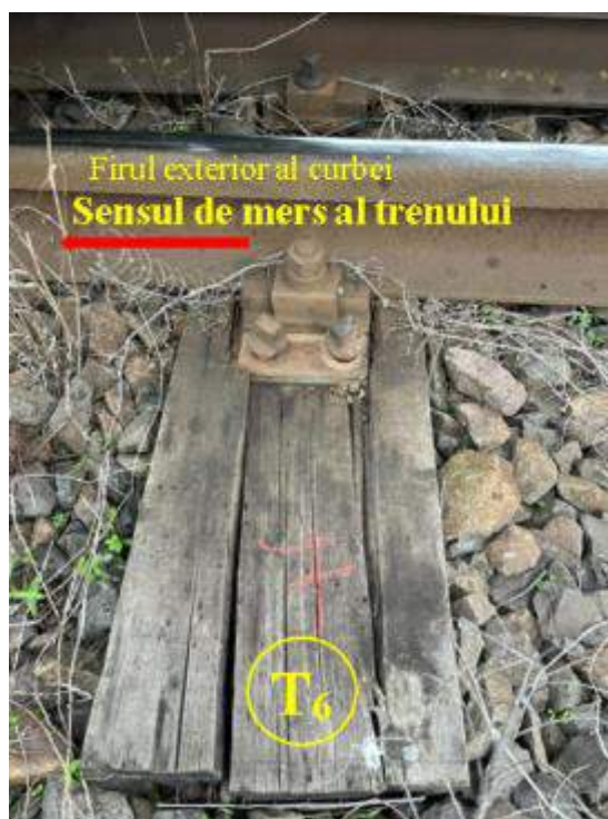
Foto nr.27 - Capătul traversei T_6 pe firul exterior
