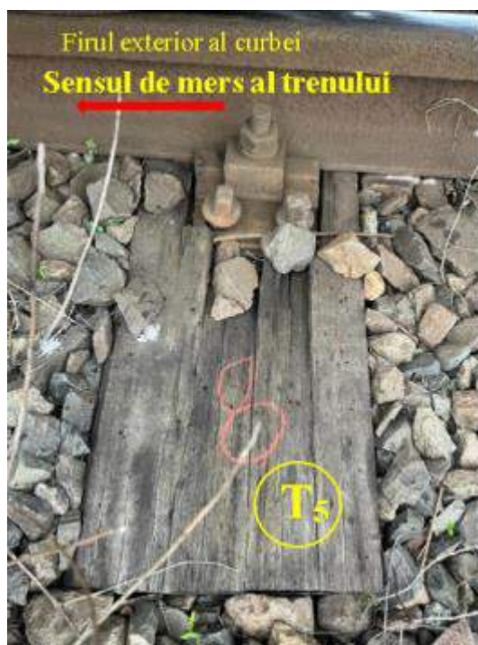
Foto nr.25 - Capătul traversei T_5 pe firul exterior
