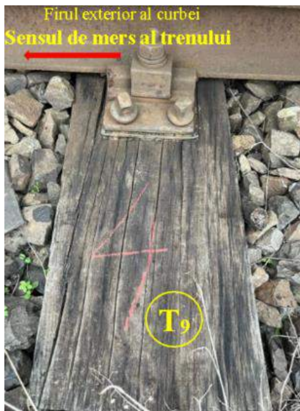
Foto nr.33- Capătul traversei T_9 pe firul exterior
