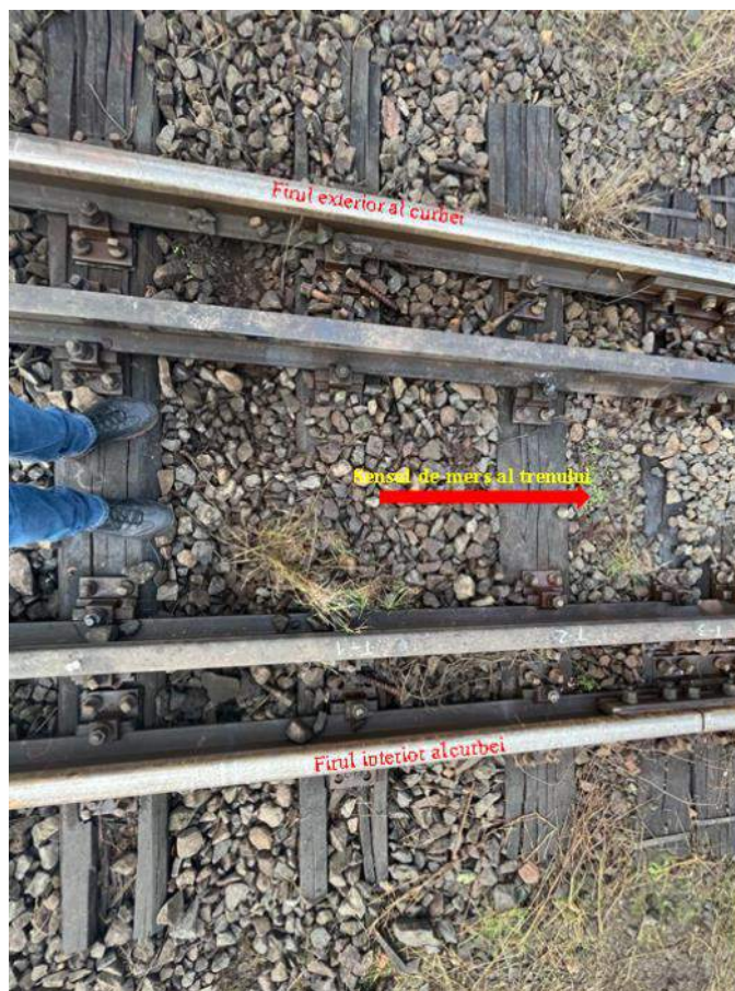
Foto nr. 14 - Starea tehnică a traverselor T_{-1} , T_{-2} și T_{-3}
