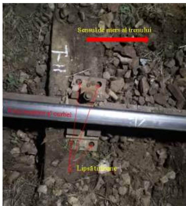
Foto. nr.3 – Starea tehnică a traversei T-11
