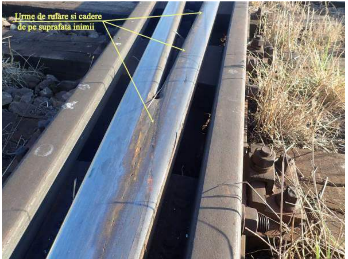
foto nr.3 – urme de rulare în stare deraiată pe inima schimbătorului
