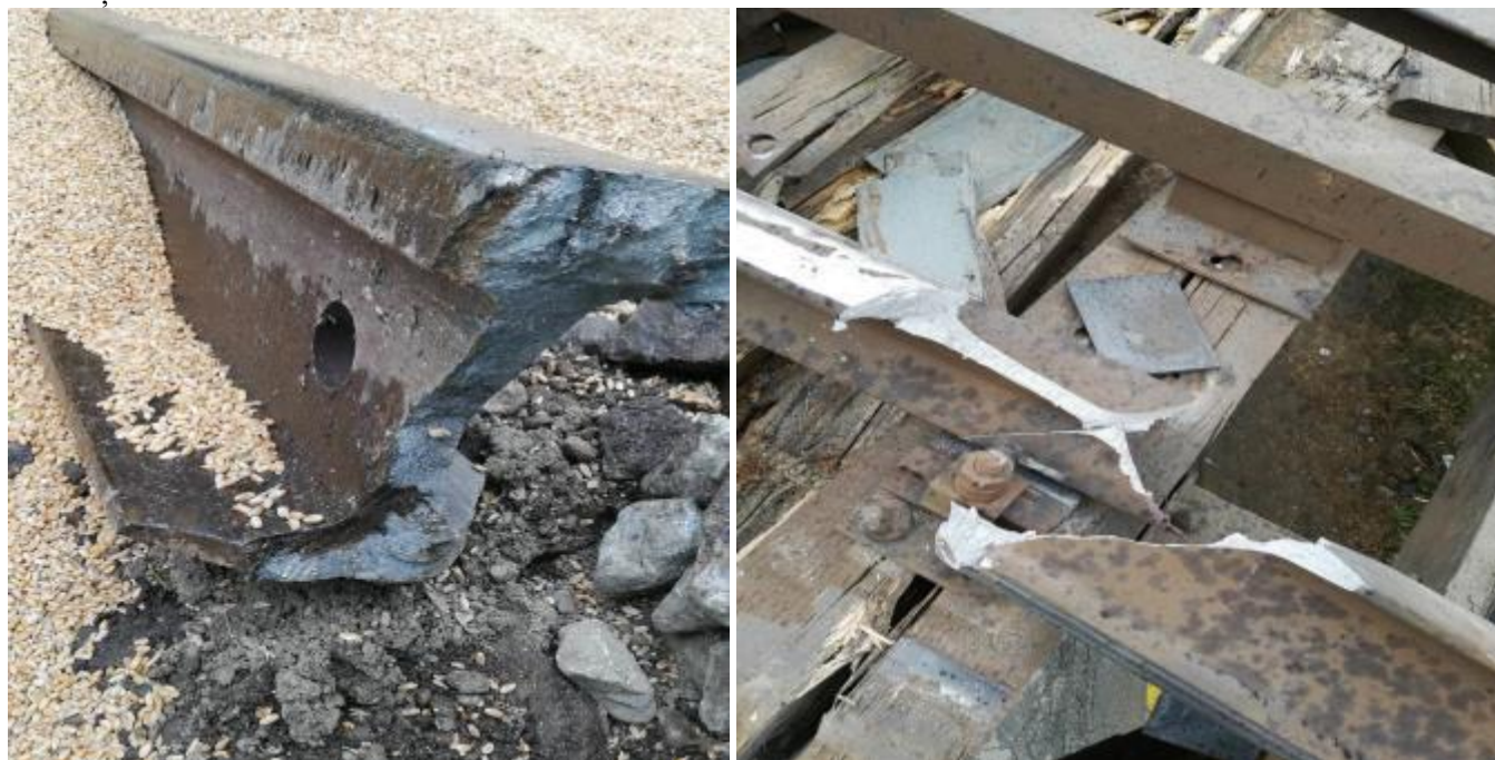
foto nr. 12,13: diverse secțiuni de rupere a șinei de pe firul exterior al curbei
