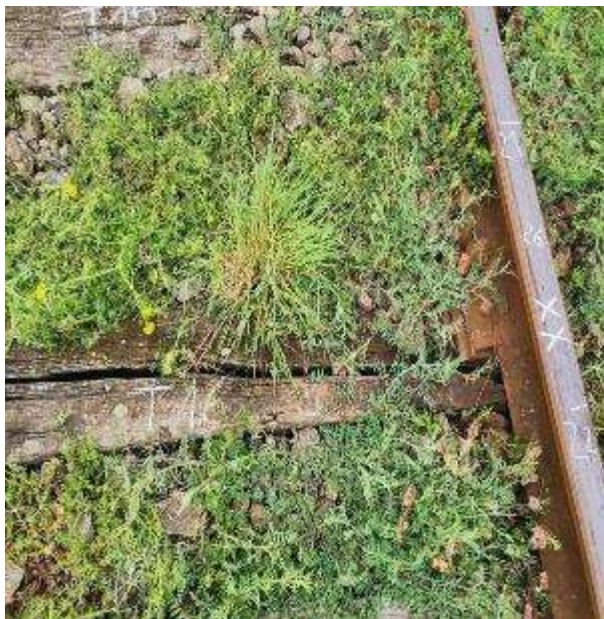
Foto. nr.9 – Starea tehnică a traversei T 16
