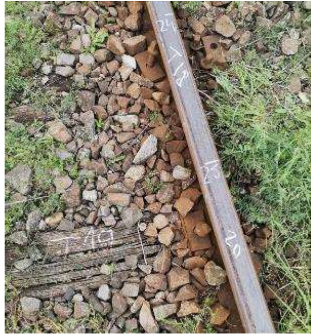
Foto. nr.8 – Starea tehnică a traverselor T 19 și T 18
