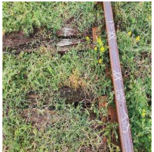
Foto. nr.10 – Starea tehnică a traverselor T 9 și T 8
