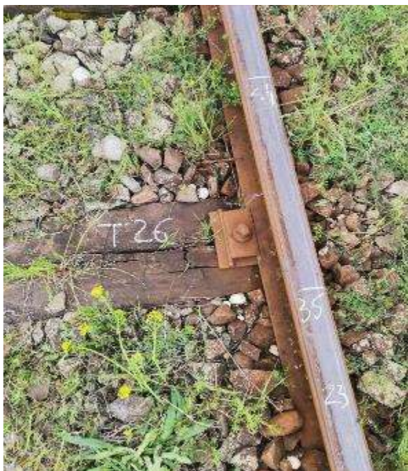
Foto. nr.5 – Starea tehnică a traversei T 26
