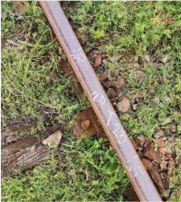
Foto. nr.7 – Starea tehnică a traversei T 23
