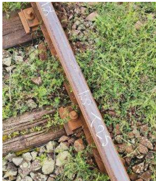
Foto. nr.6 – Starea tehnică a traversei T 25
