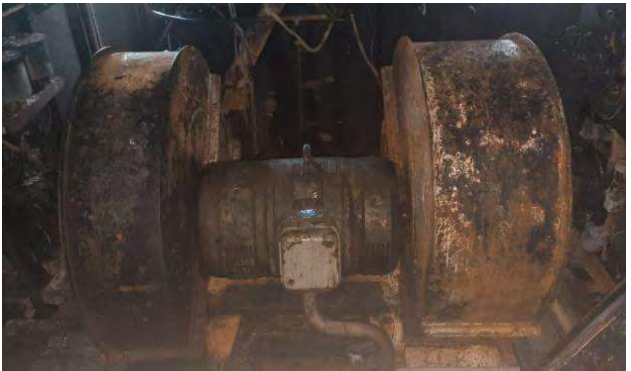
Foto nr.4. Grup ventilație boghiu 2 afectat termic
