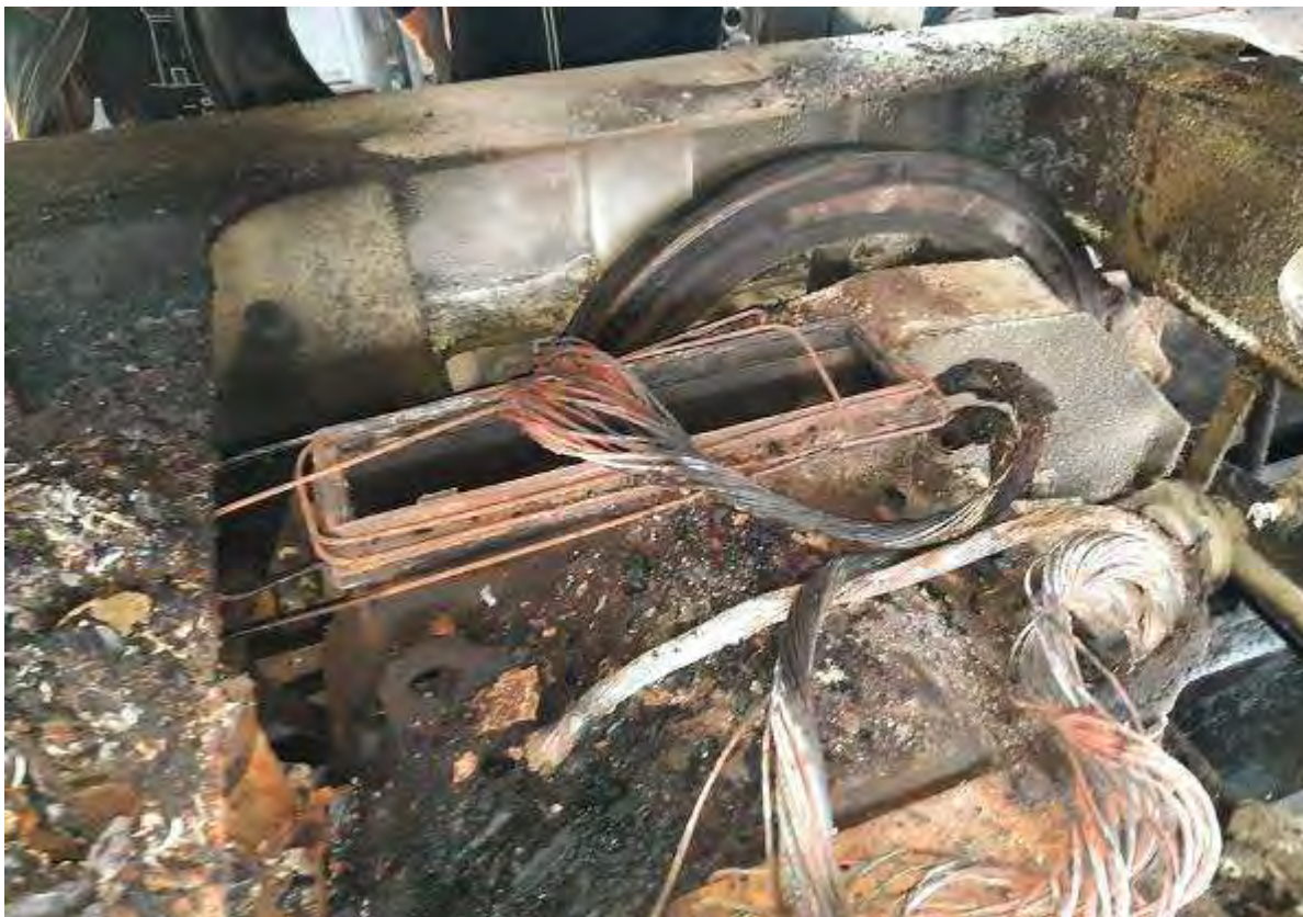
Foto nr.5. Motor de tracțiune nr.4 cu cablajul ars și reziduuri (ulei, motorină și apă) depuse pe motor și pe boghiu
