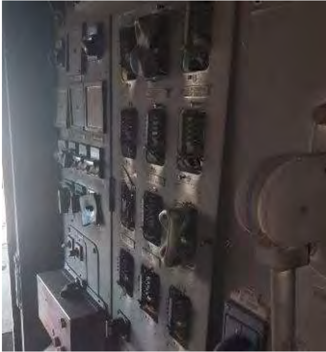
Foto nr.2. Blocul de aparate cu elementele din material plastic deformate
