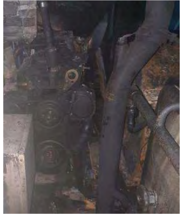
Foto nr.3. Motorul diesel auxiliar (MDA) afectat termic
