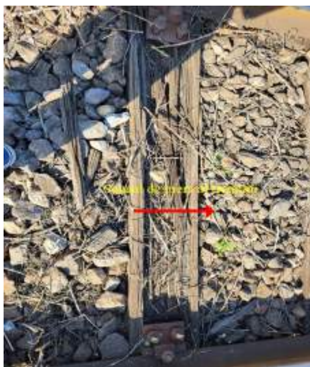
Foto. nr.12 – Starea tehnică a traversei T 15
