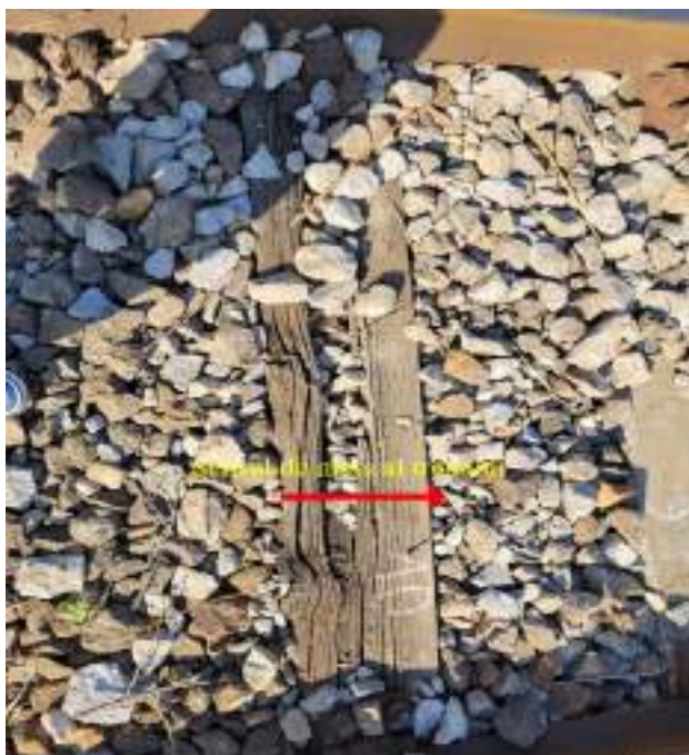
Foto. nr.10 – Starea tehnică a traversei T 10
