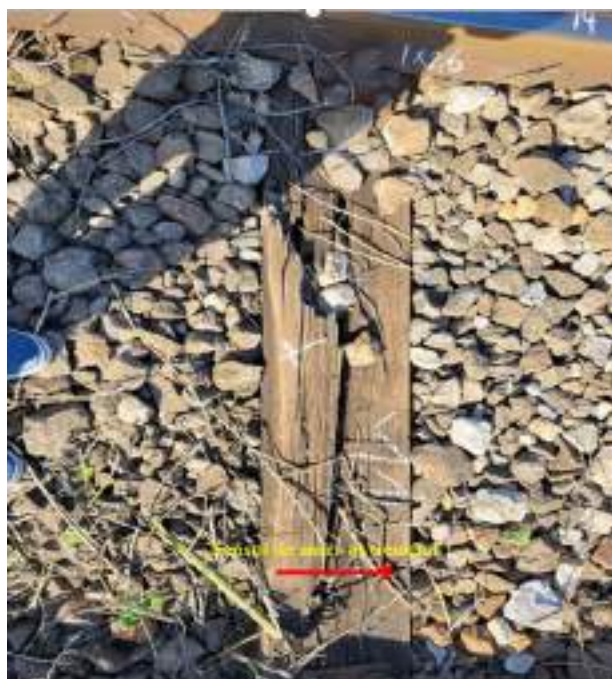
Foto. nr.11 – Starea tehnică a traversei T 11
