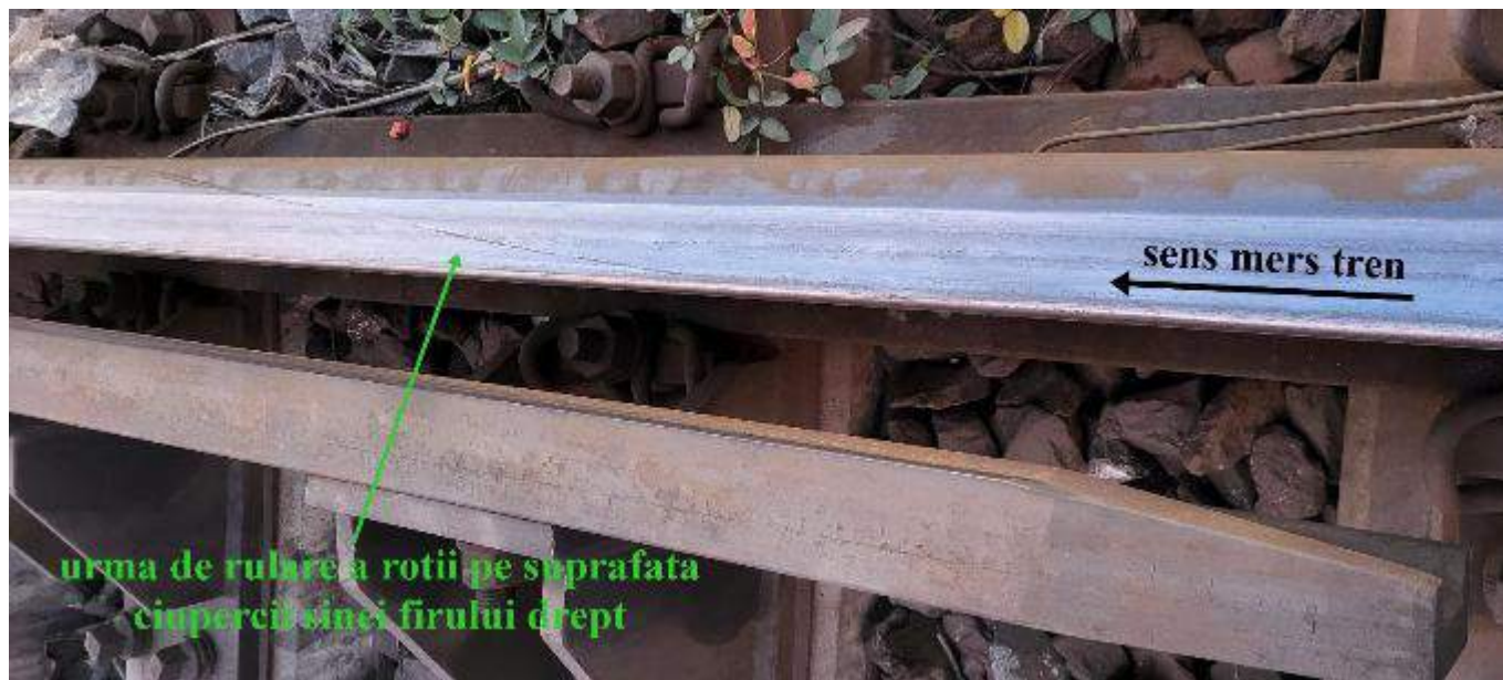
Figura nr.2 - Prima urmă de circulație deraiată
