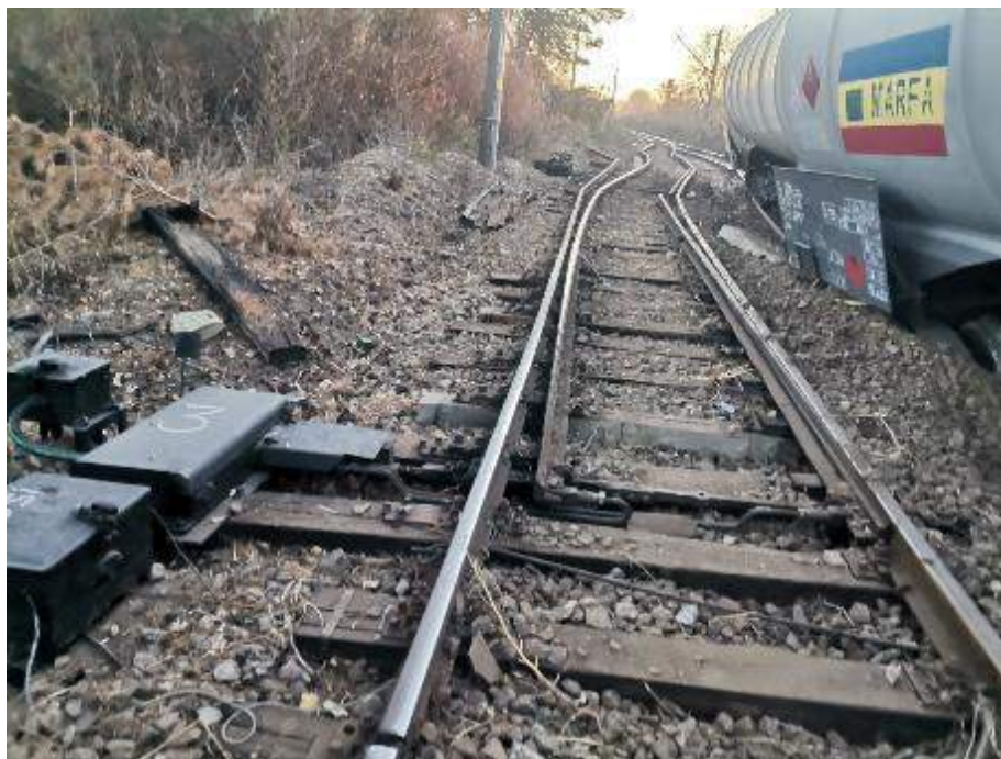
Foto nr.11 – Schimbătorul de cale nr.3 după deraiere
