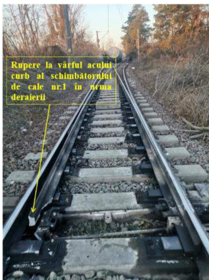
Foto nr.10 – Schimbătorul de cale nr.1 după deraiere
