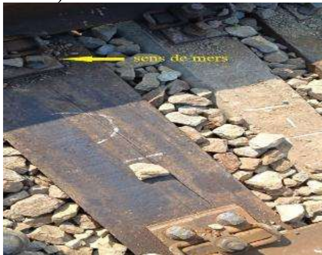
Foto nr.8 starea traverselor în punctul „0”
