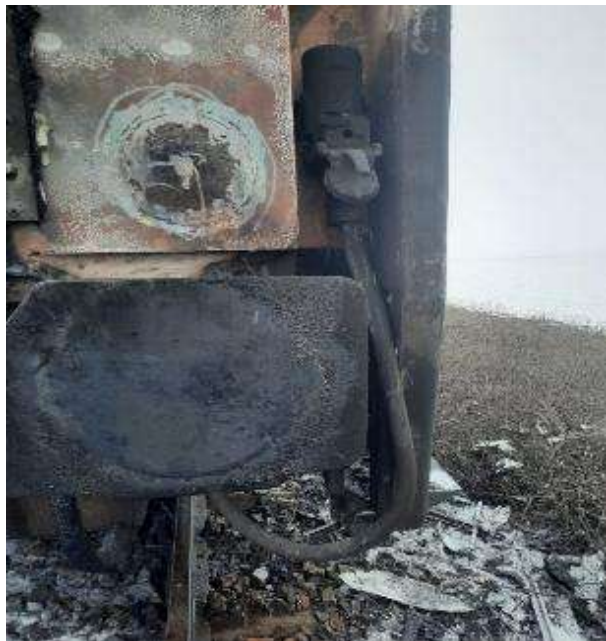
Imaginea nr.3 – Fișa și priza de la capătul cu frâna de mână, corespunzător boghiului cu roțile 5-8, nu avea urme de conturare (scurtcircuit)
