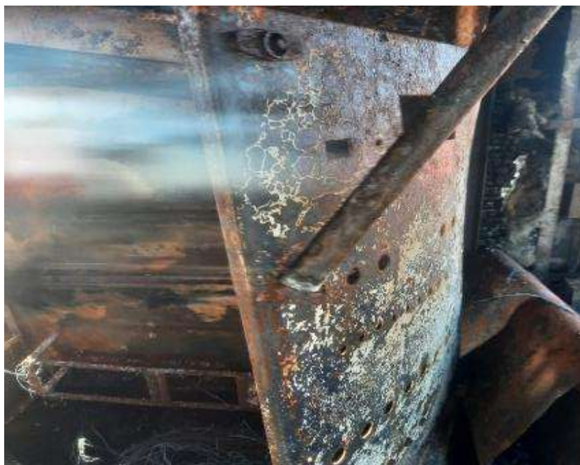
Imaginea nr.6 – zona tabloului electric de comandă al vagonului cu detaliu al afectării termice a cutiei acestuia
