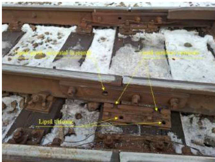
Foto nr.23 – Lipsa unor șuruburi verticale, orizontale și tirfoane
