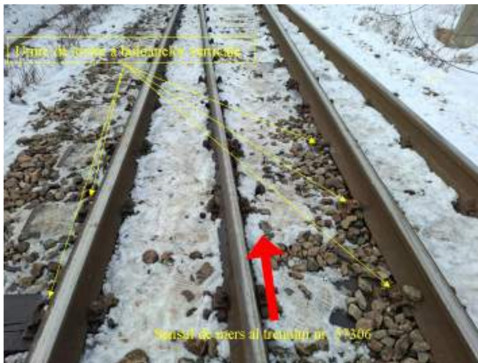
Foto nr.14 – Urme de lovire a buloanelor verticale pe zona șinelor de legătură a schimbătorului de cale nr.10
