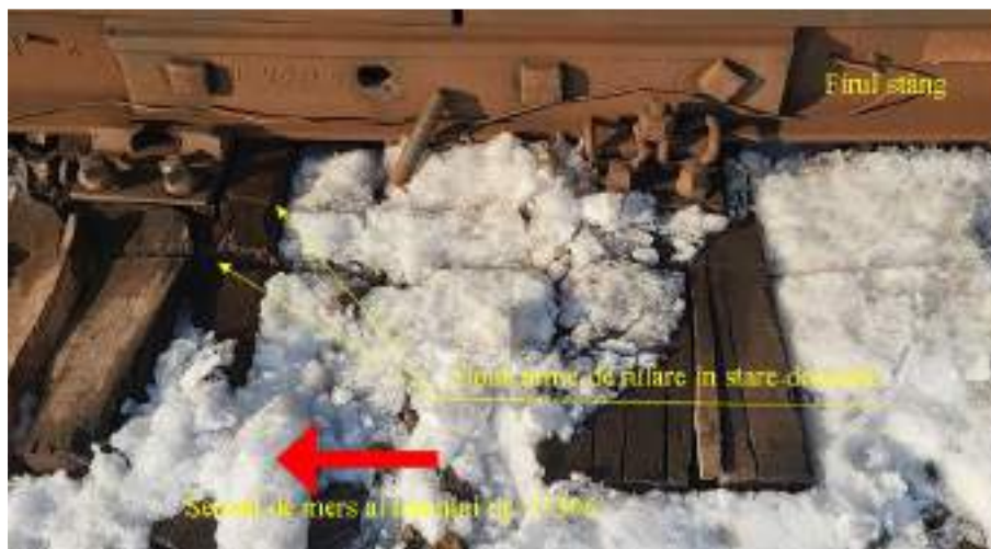
Foto nr.16 – Două urme de rulare în stare deraiată la vârful macazului nr.10 de pe firul stâng
