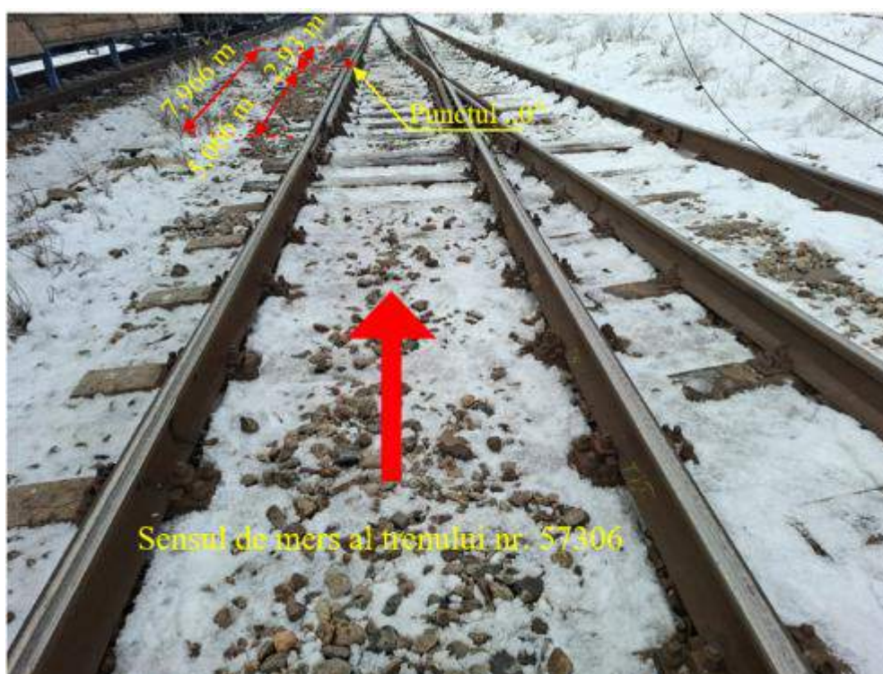
Foto nr.10 – Locul producerii deraierii pe schimbătorul de cale nr.10
