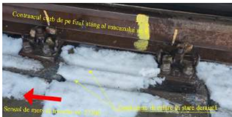
Foto nr.18 – Două urme de rulare în stare deraiată pe macazul schimbătorului de cale nr.8
