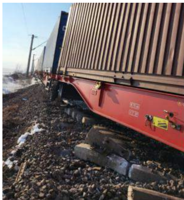
Foto nr.22 – Traverse deteriorate și șine rupte pe firul II
