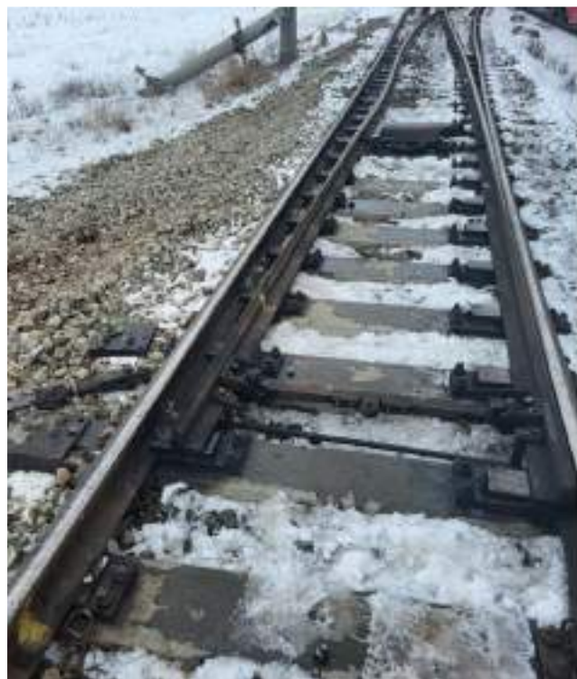
Foto nr. 20 – Schimbătorul de cale nr.2 după accident
