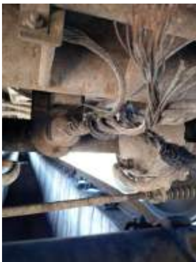
Foto nr.1 – Cablu oțel rupt
