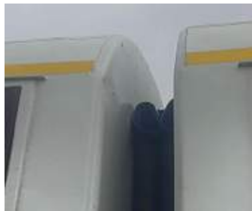
Foto nr.5 – Perete frontal deformat la partea superioară
