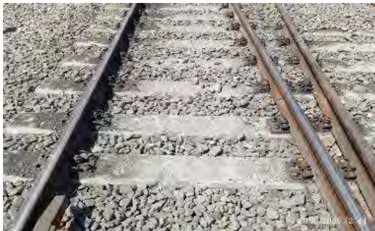
Foto. nr.12 și 13 – Starea traverselor aflate în cale și gradul de colmatare a prismei de piatra spartă
