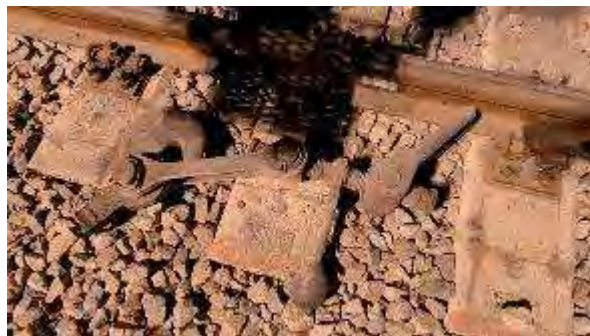
Foto nr.2 - Cârlig aparat de tracțiune rupt
