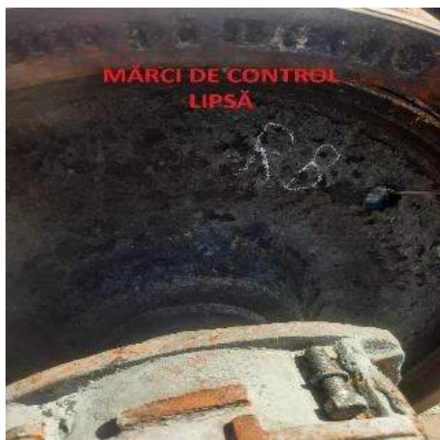
Foto nr.6 – R8, mărci de control lipsă;
