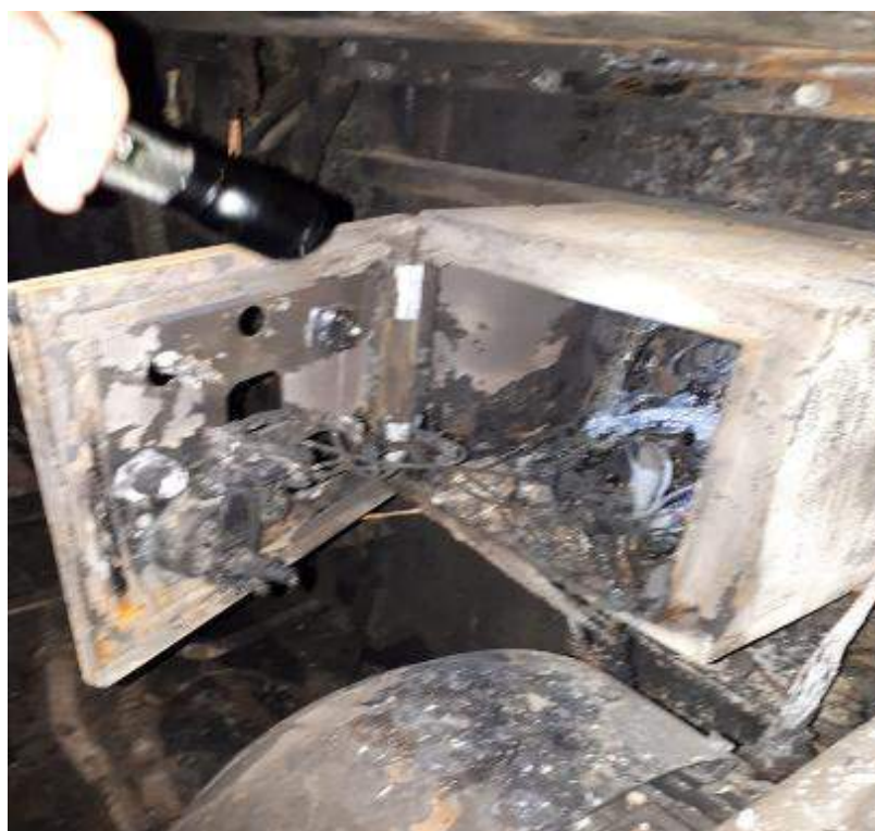
Foto nr.6. Tabloul de comandă și supraveghere al compresorului (combistat cu relee) cu tot echipamentul electric afectat termic. (90%)
