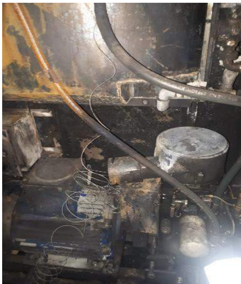
Foto nr.8. Ansamblu compresor afectat termic cu furtun aspirație aer ars și topit (rămasă doar inserția metalică).
