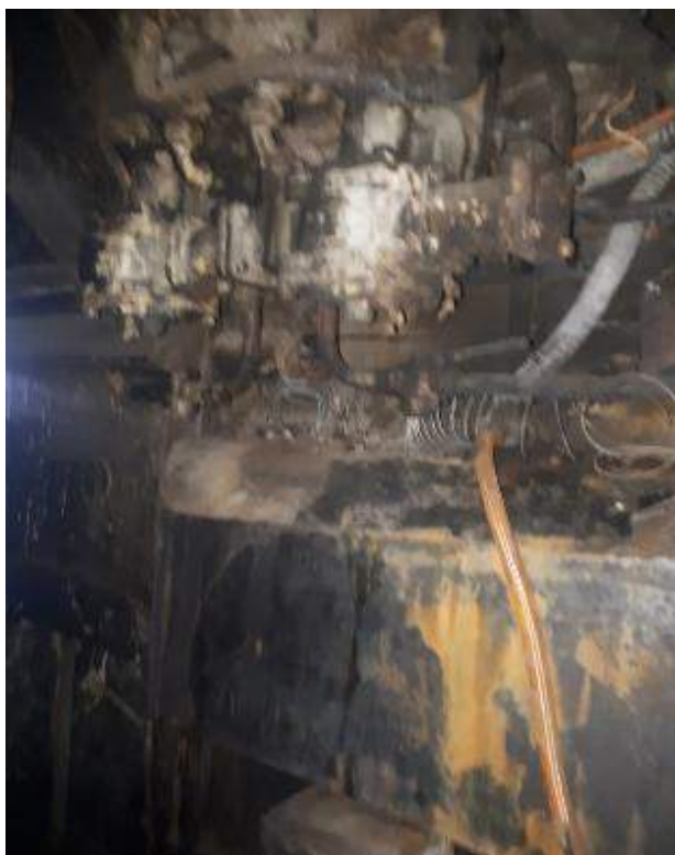
Foto nr.3 Zona afectată termic (panoul pneumatic) deasupra tabloului de comandă și supraveghere al compresorului
