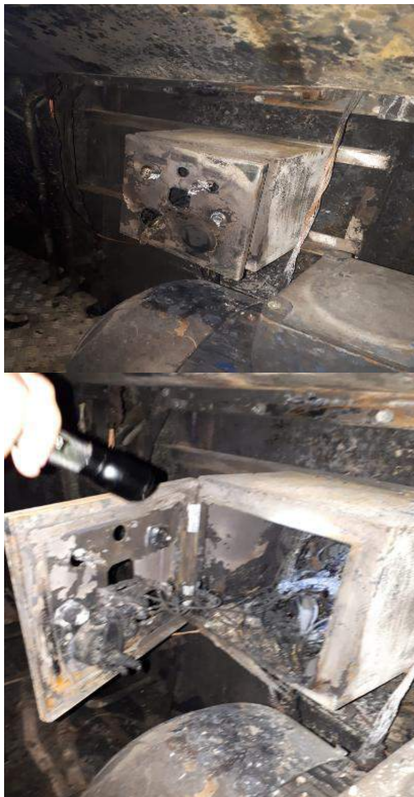
Foto nr.2. Tabloul de comandă și supraveghere al compresorului puternic afectat termic.
