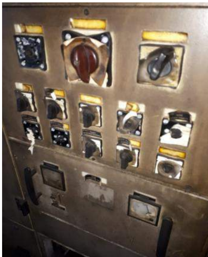
Foto nr.5. Ușa blocului de aparate cu elementele din material plastic deformat
