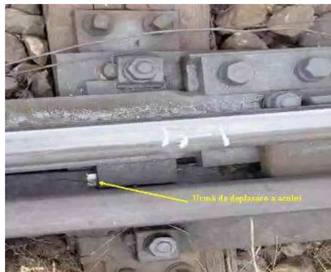
Foto nr.24 – Urmă deplasare longitudinală a acului
