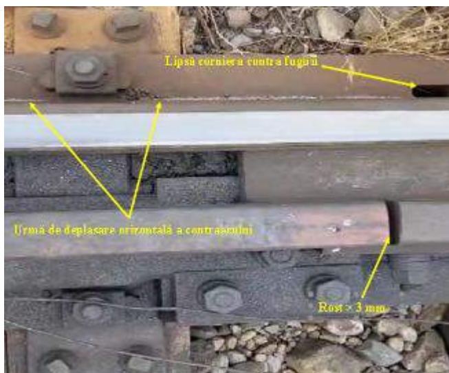
Foto nr.23 – Urmă deplasare laterală contraac
