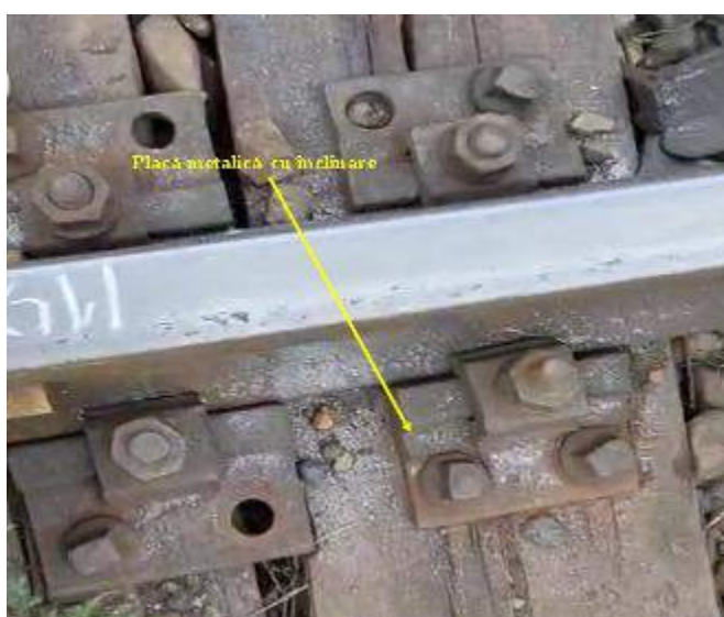
Foto nr.15 – Placă metalică cu înclinare
