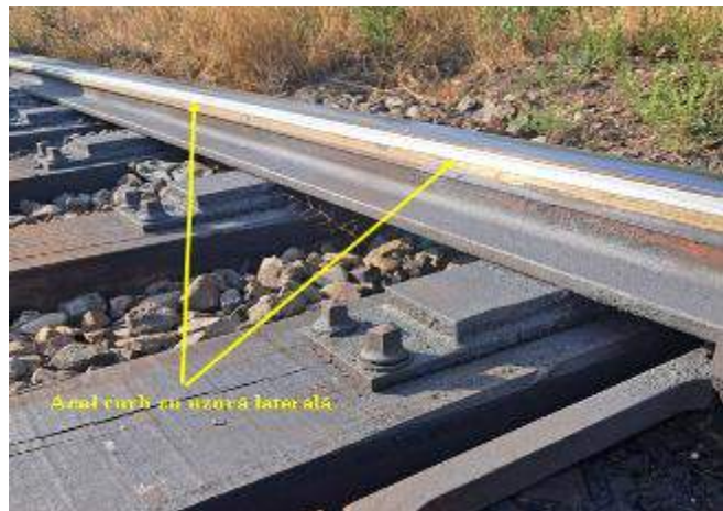
Foto nr.26 – Urmă de uzură laterală a acului
