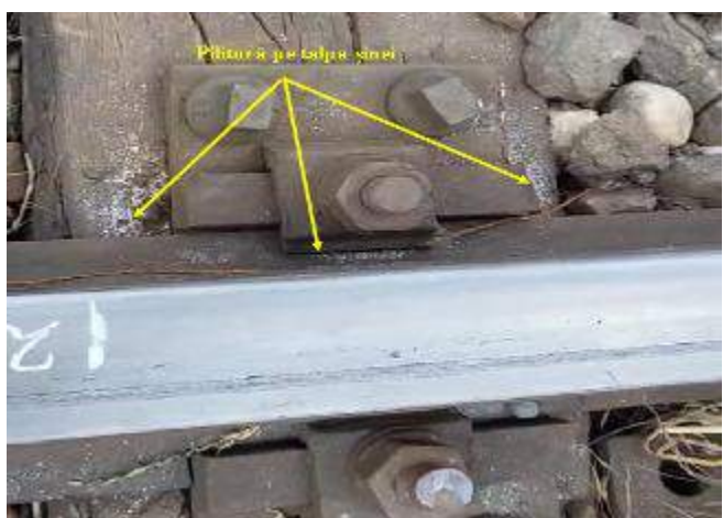
Foto nr.28 – Urmă de pilitură pe talpa șinei
