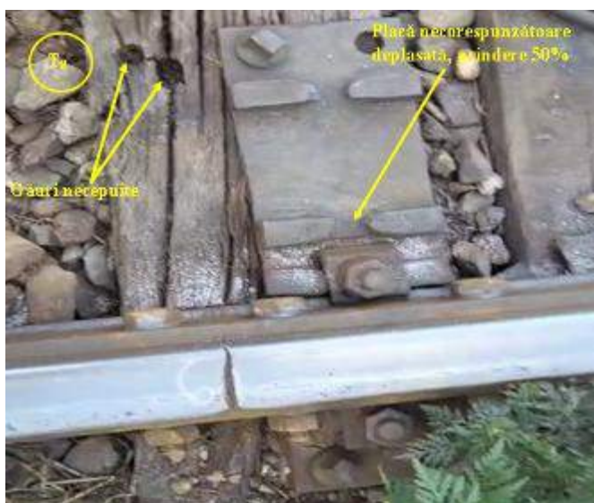
Foto nr.7 – Traversa T 8
