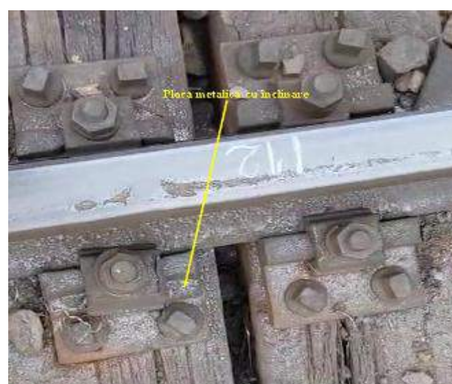
Foto nr.16 – Placă metalică cu înclinare
