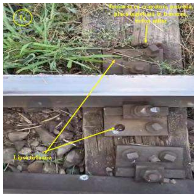
Foto nr.6 – Traversa T 6
