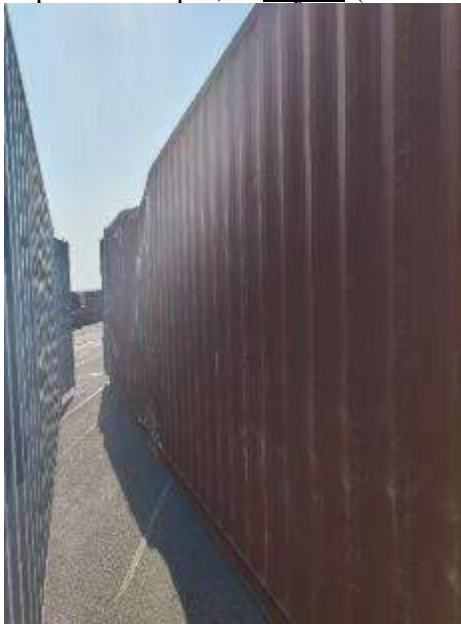
Foto nr.12 - Perete container partea dreaptă avariata
