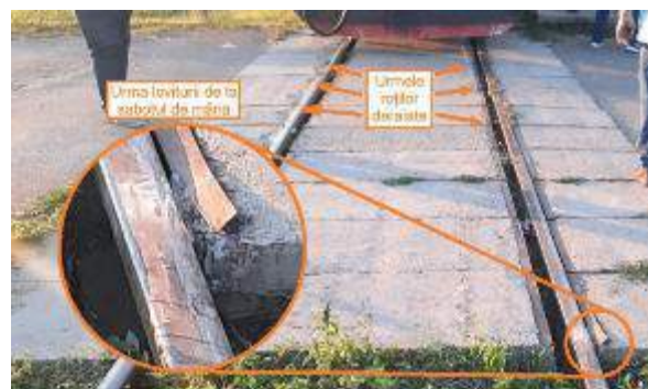
Foto nr.5 – Urme pe dalele pasajului
