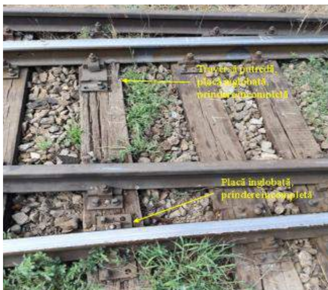
Foto nr.7 – Traversa T 5
