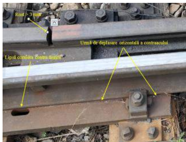
Foto nr.18 – Urmă deplasare laterală contraac
