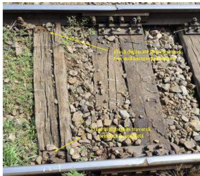
Foto nr.6 – Traversa T -18
