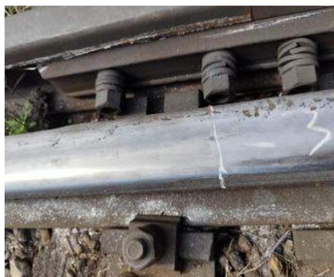
Foto nr.14 – Urmă de pilitură pe talpa șinei
