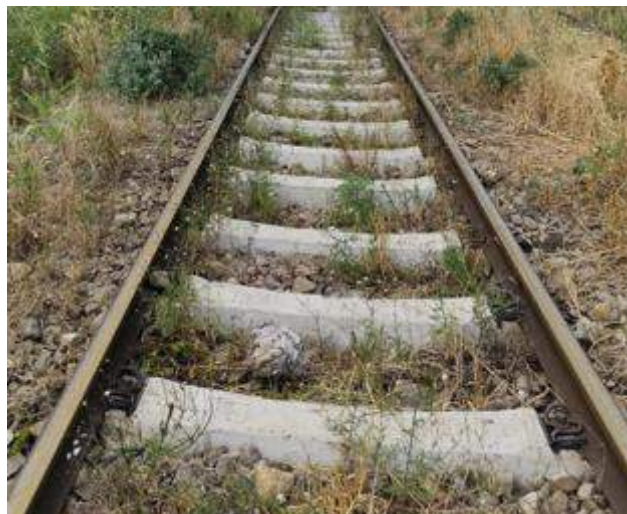
Foto.nr.10 – Piatră spartă colmatată cu vegetație
