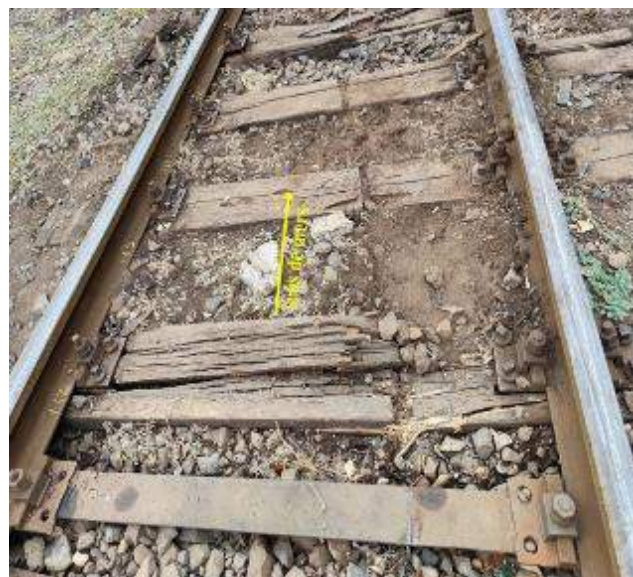
Foto nr.6 – Urme de rulare în stare deraiată între firele căii
