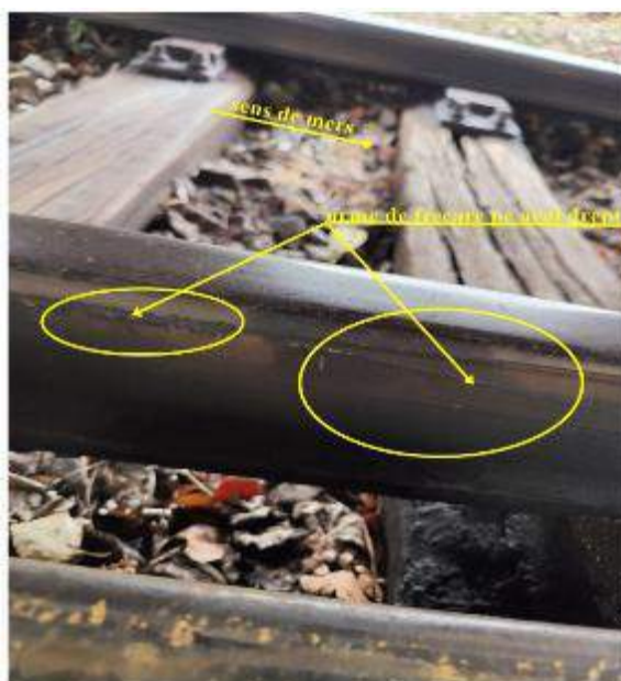
Foto nr.4 – Urme de frecare între acul drept și contraacul curb
