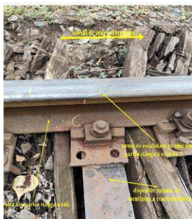
Foto nr.17 - punctul de reper „C” - escaladare a ciupercii șinei a rotii 3L a osiei nr.2
