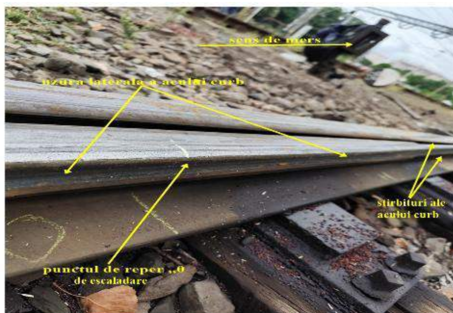
Foto nr.25 – uzură laterală pe acul curb în zona punctului de reper „0” și știrbituri ale acestuia
