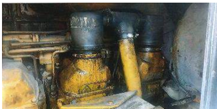
Foto nr.2 – Ansamblului epuratoarelor de gaze montat pe motorul Caterpillar 3508 B
