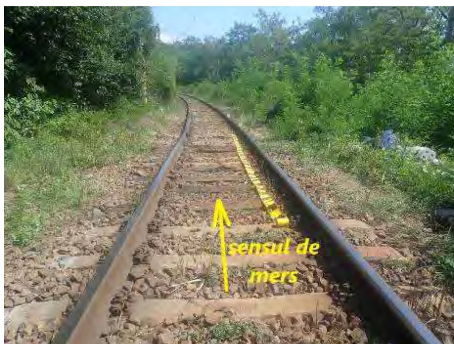
Foto nr.1 – zona producerii accidentului
