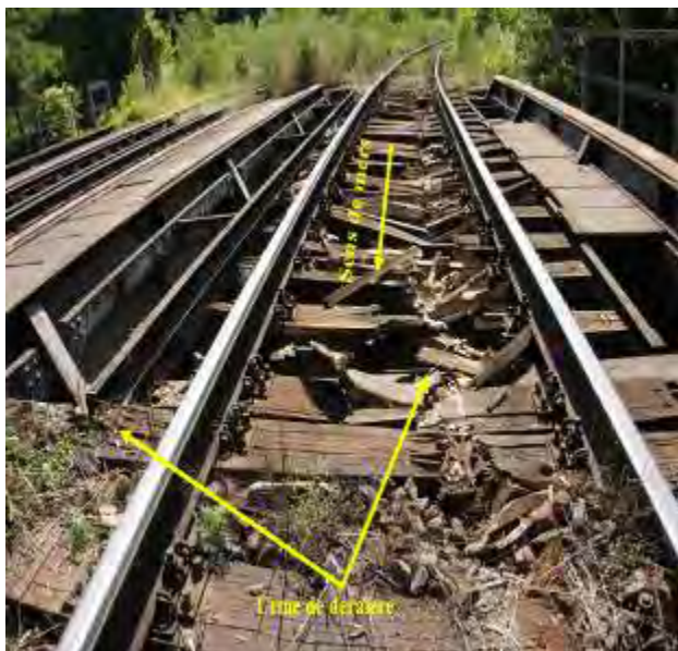
Foto nr.10 – Urme de deraiere
