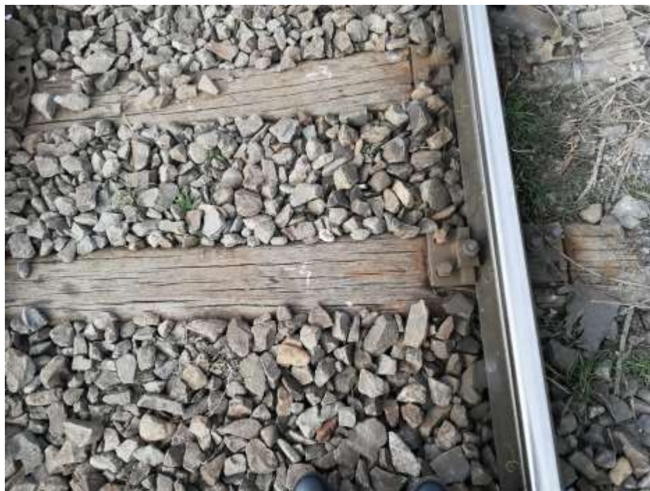
Foto. nr.4 – Prinderea șinei de traverse la traversele nr.-3, și nr.-4, pe firul exterior al curbei
