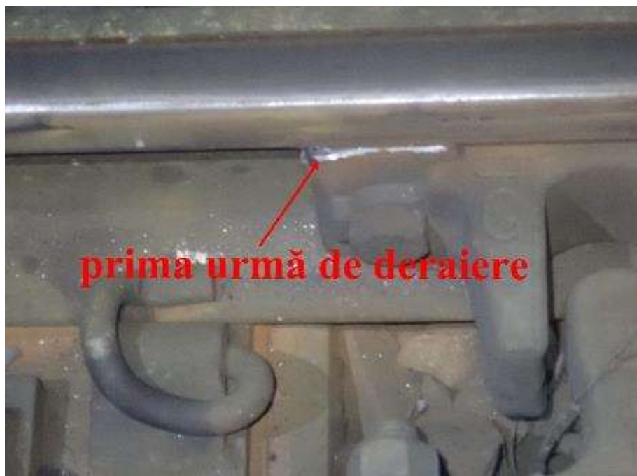
FOTO nr.1, prima urmă de lovire și deraiere
