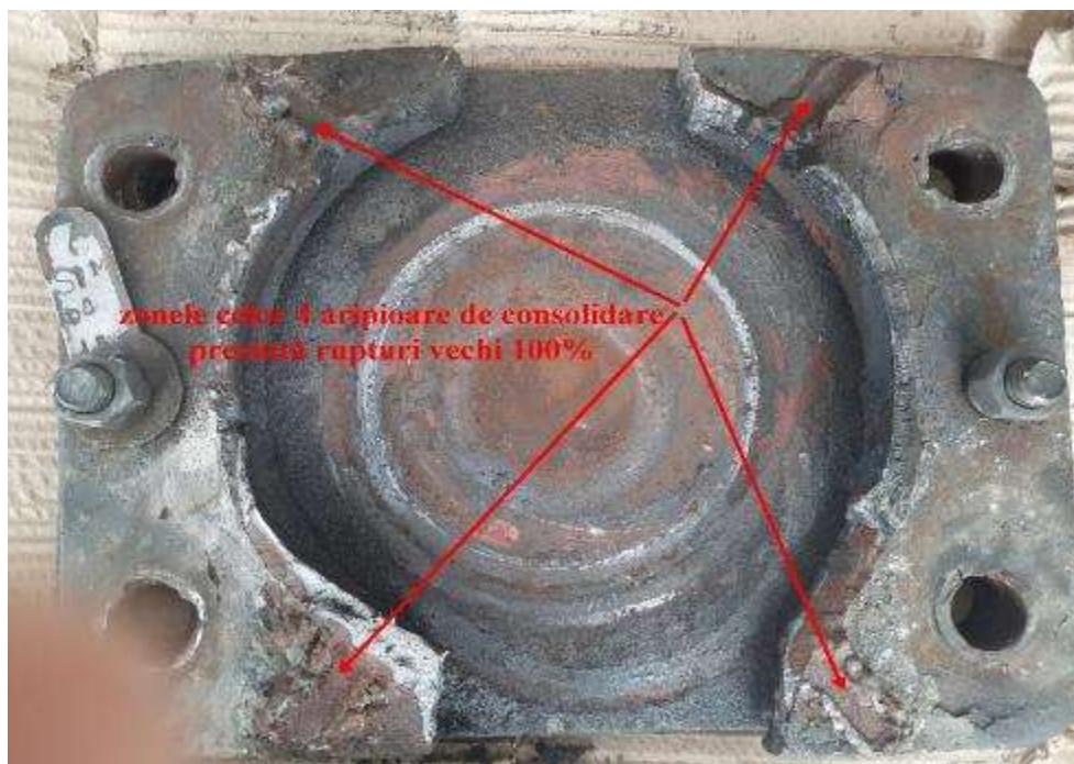
FOTO nr.3, zonele celor 4 aripioare de consolidare prezintă rupturi vechi 100%
