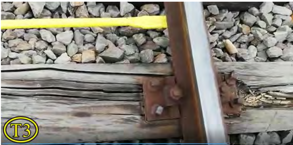
Foto. nr.15 – Prinderea șinei de traverse la traversa T3,pe firul exterior al curbei
