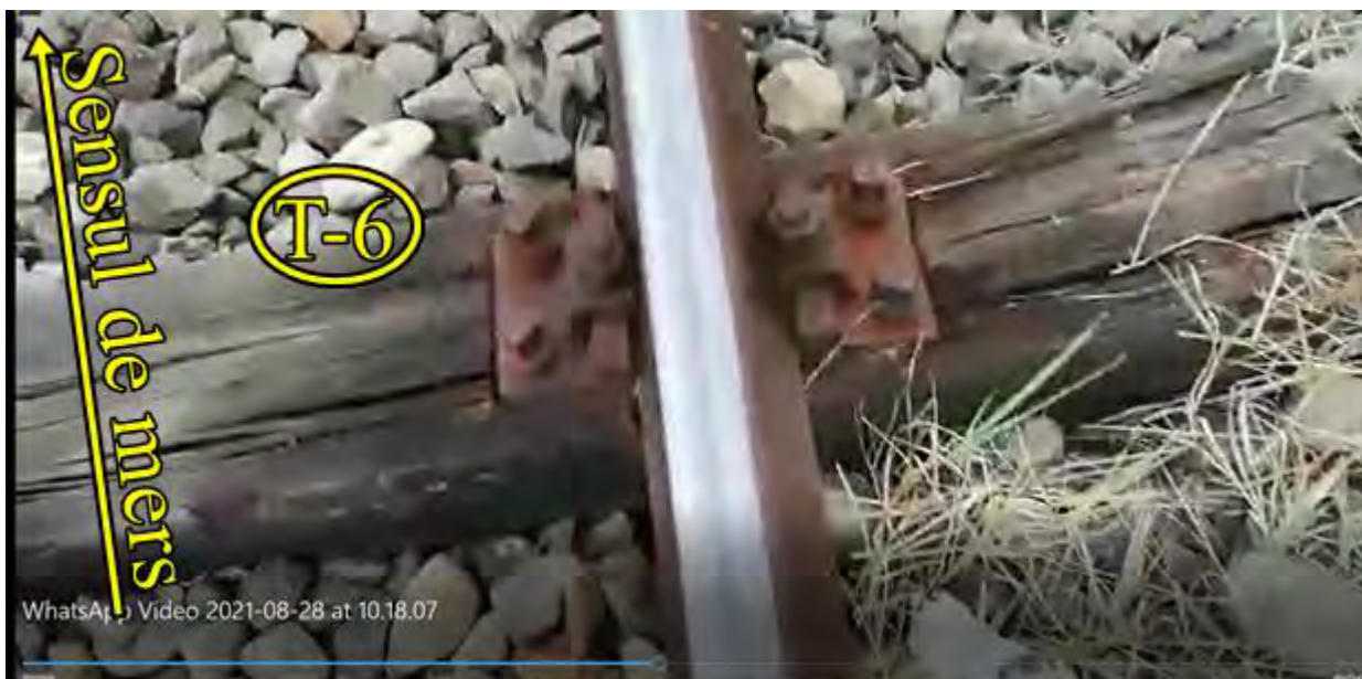
Foto. nr.8 – Prinderea șinei de traverse la traversa T-6,pe firul exterior al curbei
