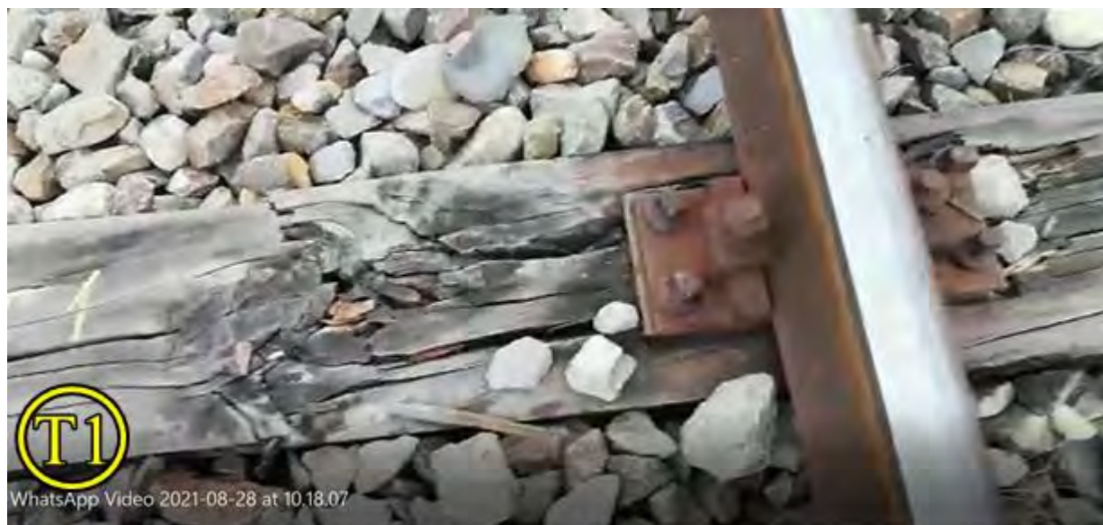
Foto. nr.13– Prinderea șinei de traverse la traversa T1,pe firul exterior al curbei
