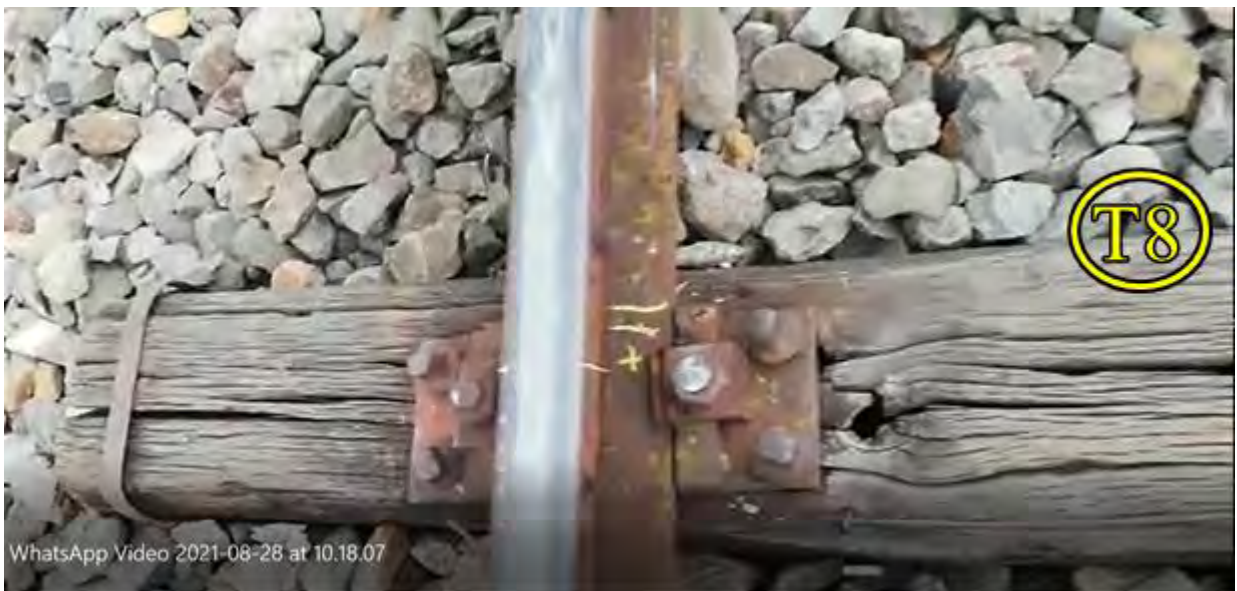
Foto. nr.18 – Prinderea șinei de traverse la traversa T8, pe firul interior al curbei
