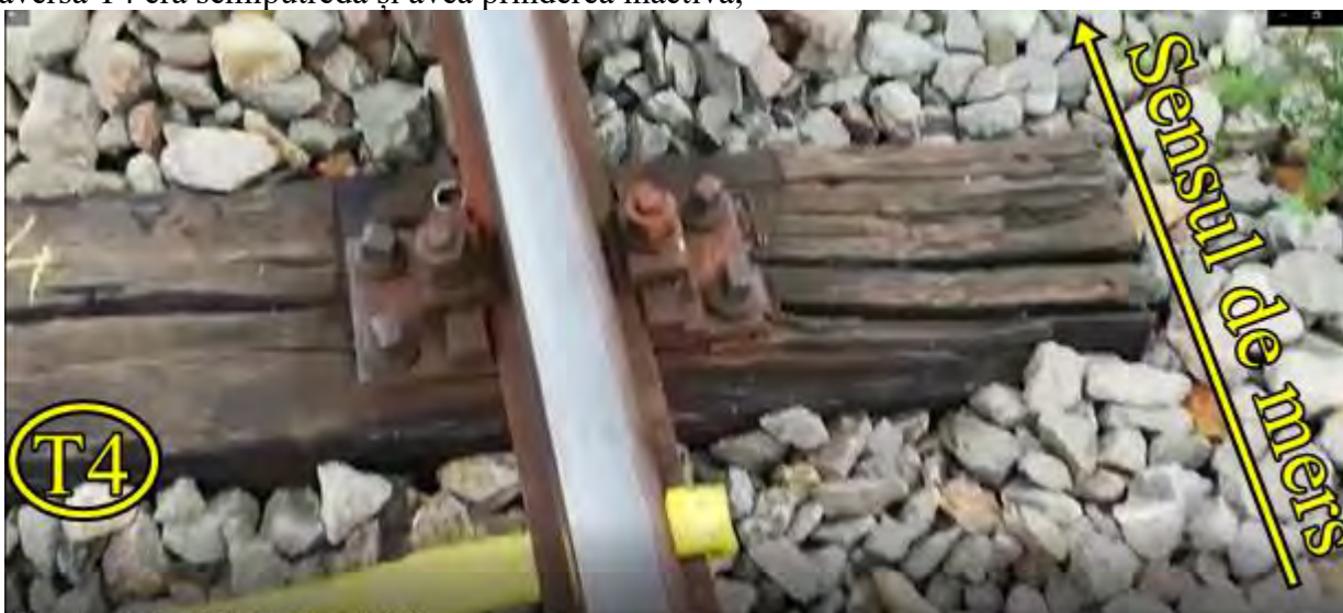
Foto. nr.16 – Prinderea șinei de traverse la traversa T4,pe firul exterior al curbei
