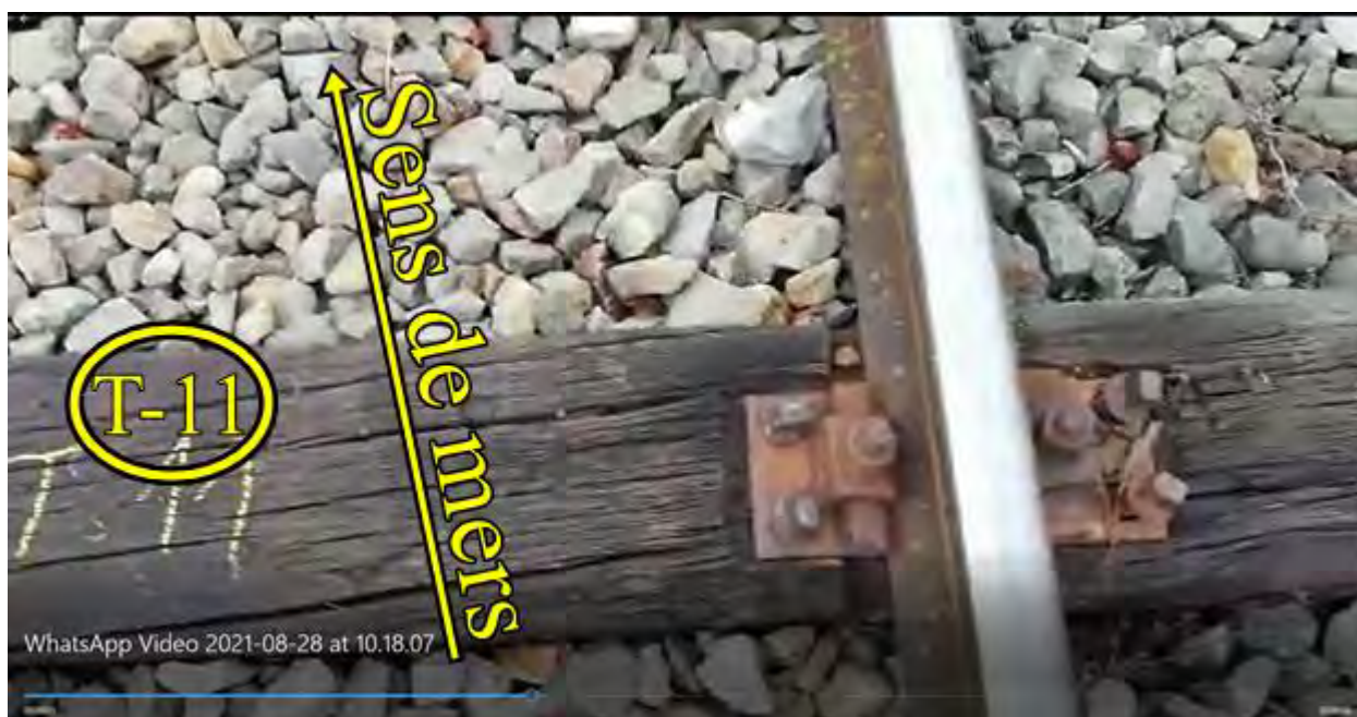
Foto. nr.11 – Prinderea șinei de traverse la traversa T-11,pe firul exterior al curbei
