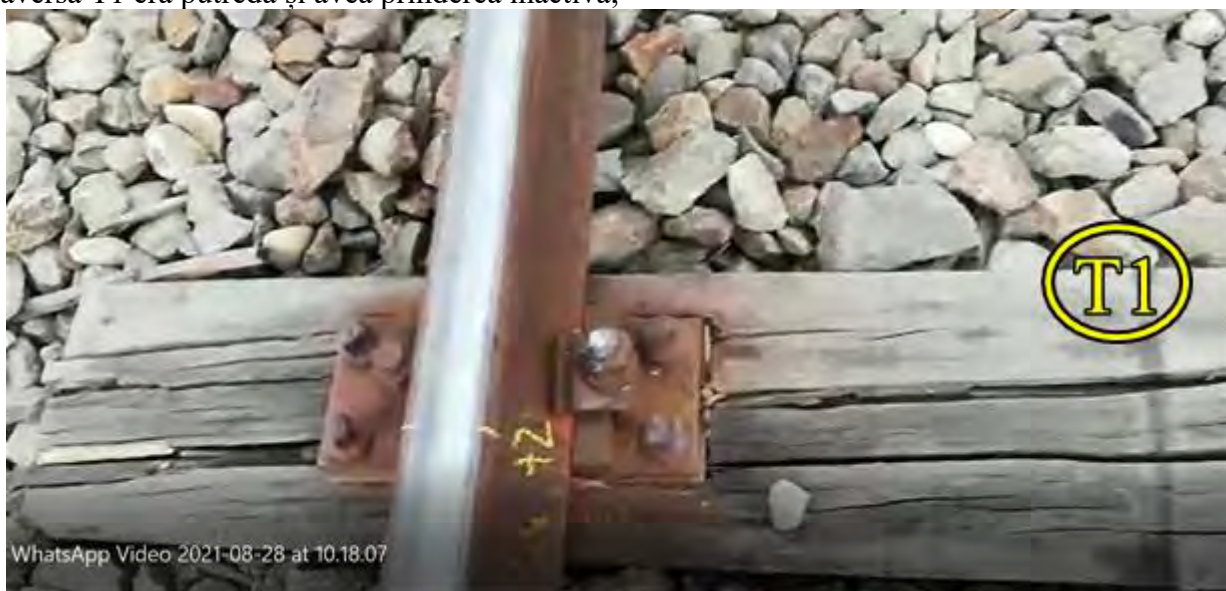
Foto. nr.12 – Prinderea șinei de traverse la traversa T1,pe firul interior al curbei
