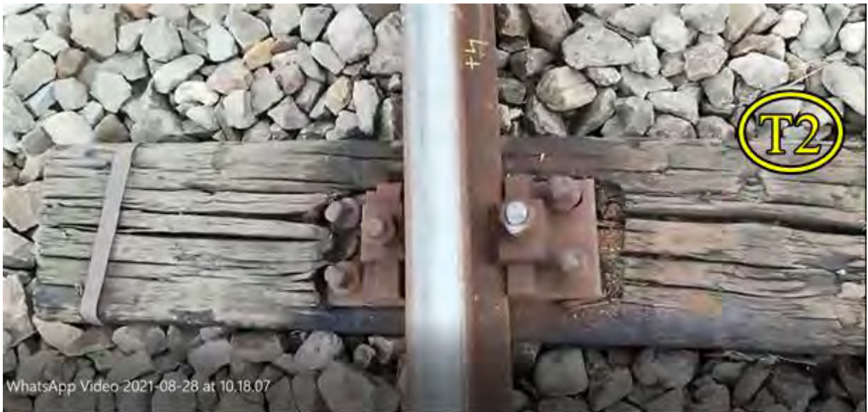
Foto. nr.2 – Prinderea șinei de traverse la traversa T2,pe firul interior al curbei
