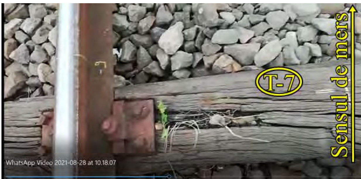
Foto. nr.9– Prinderea șinei de traverse la traversa T-7,pe firul exterior al curbei
