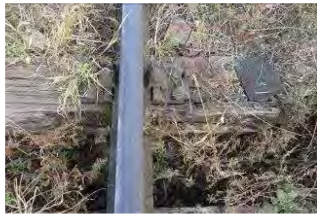
Foto nr.12 - traversa „T1”(șina din dreapta)
