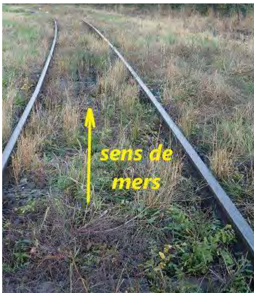
Foto nr.5 - Zone cu piatră spartă și vegetație care împiedică vizualizarea stării tehnice a traverselor în zona de fixare a plăcilor metalice
