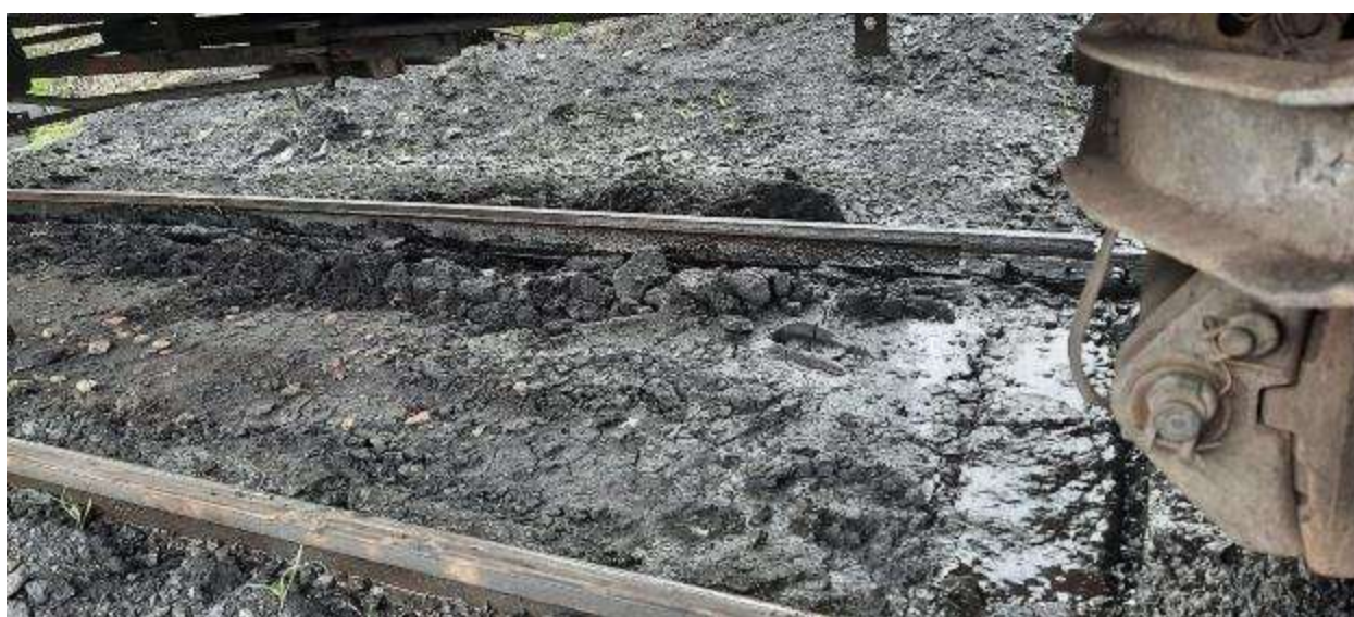
Foto nr.4: Detaliu grad de colmatare a prisme de piatră spartă.
