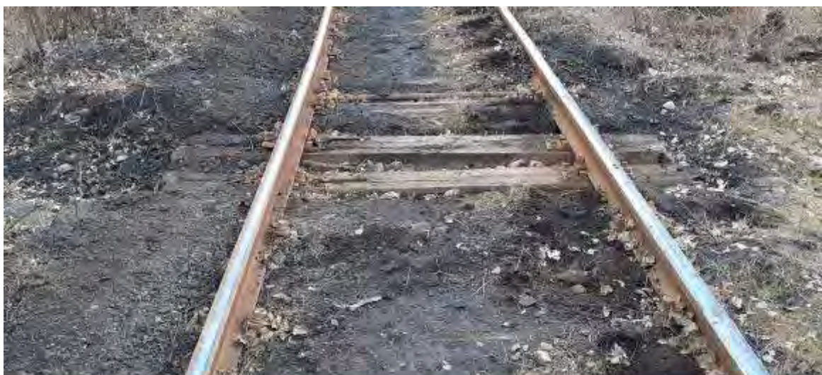
Foto nr.10: starea liniei după deraiere
