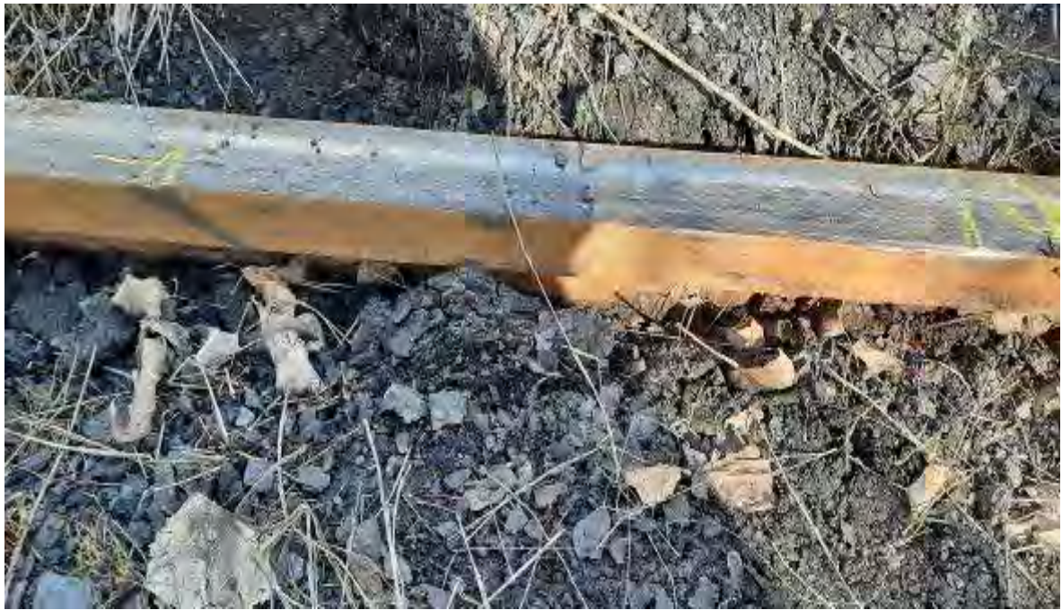
Foto nr.7: starea liniei după deraiere
