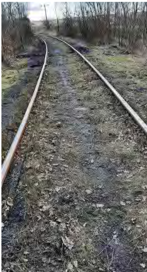
Foto nr.11: starea de colmatare a liniei în curbă
