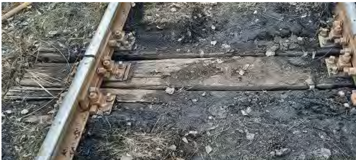
Foto nr.9: starea liniei după deraiere
