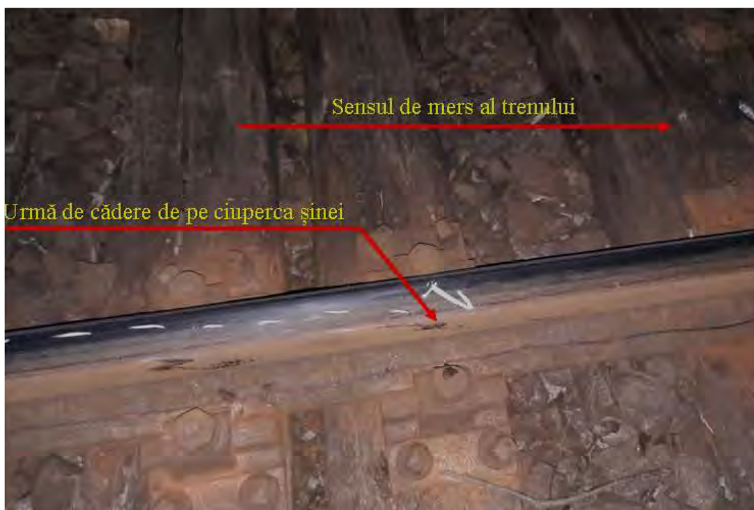
Foto nr.2 - Urmă de cădere de pe ciuperca șinei firului exterior al curbei
