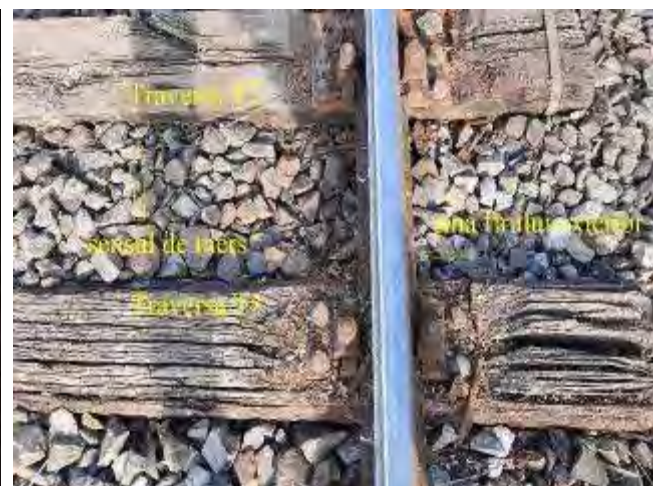
Foto.nr.8 - traversa T_3 și T_2 (după manevrarea plăcilor metalice și redeschiderea circulației)
