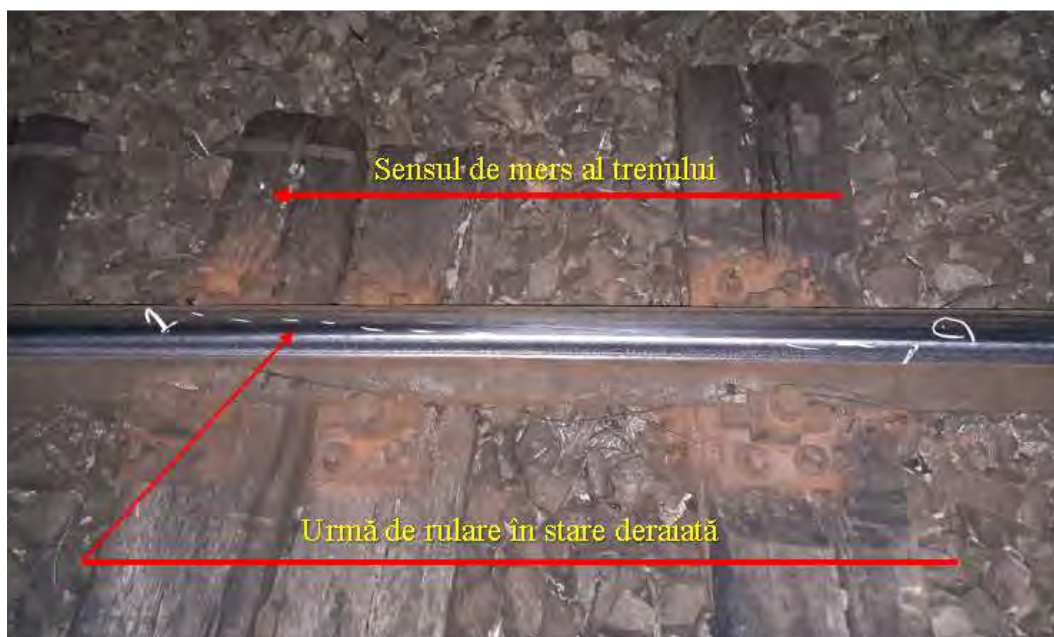
Foto nr.1 -Uрма de rulare pe ciuperca șinei firului exterior al curbei
