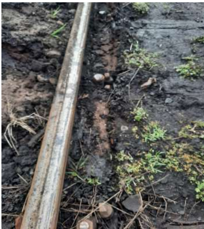
Foto nr.2: urmele lăsate de roțile deraiate
