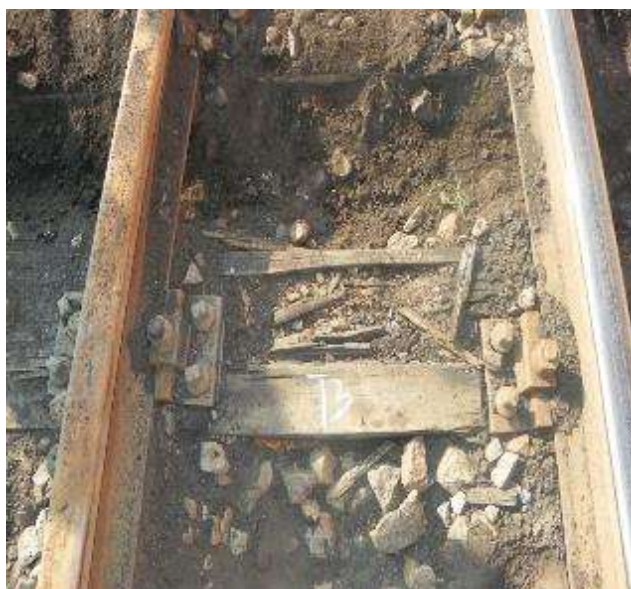
Foto nr. 8 Starea tehnică a traversei T 3
