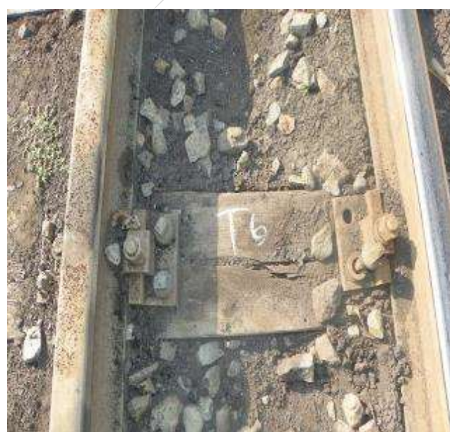
Foto nr.10 Starea tehnică a traversei T6
