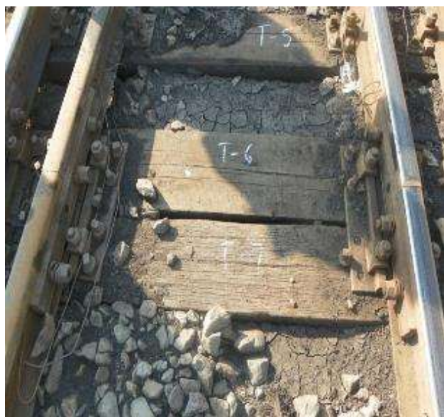
Foto nr.7 Starea tehnică a traversei T-7
