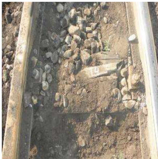
Foto nr. 9 Starea tehnică a traversei T4
