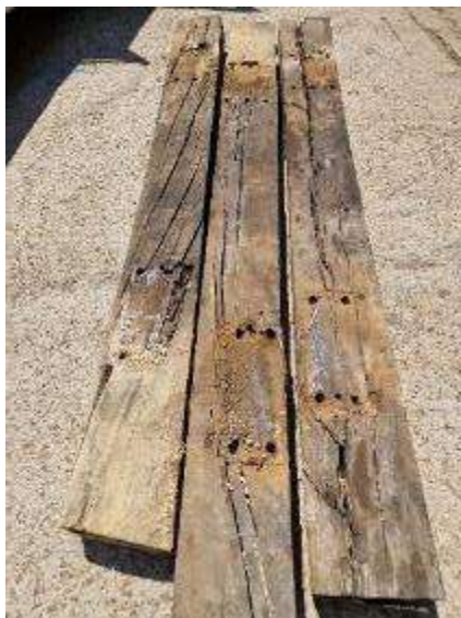
Foto nr.4, T2, 3 și 4 traverse putrede
