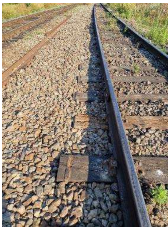
Foto nr.3, urmele și afectarea căii în urma deraierii locomotivei
