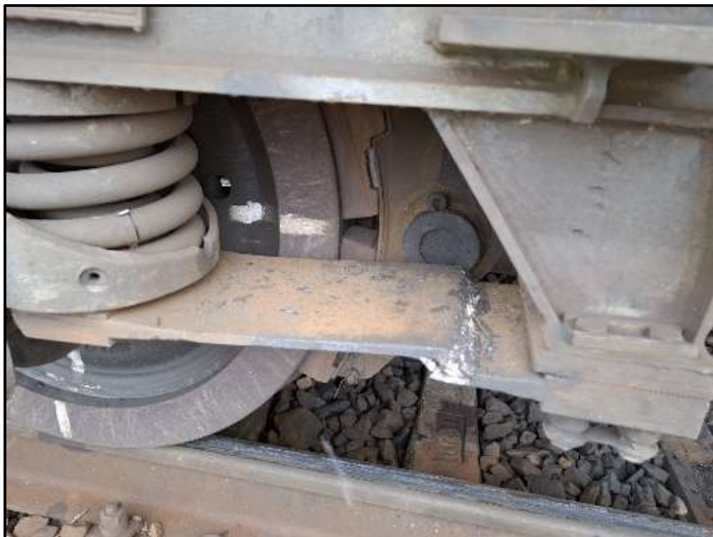
Foto nr.10 - Braț radial de la roata 2 – rupt
