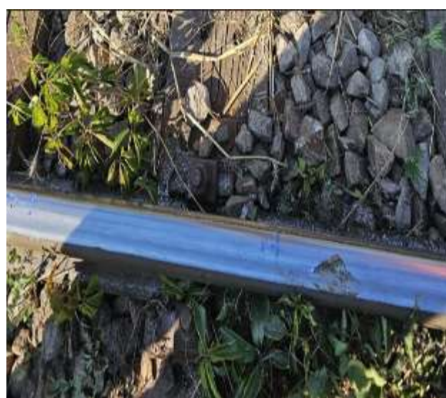
Foto.nr.18 – Pilitură pe talpa șinei și traversă
