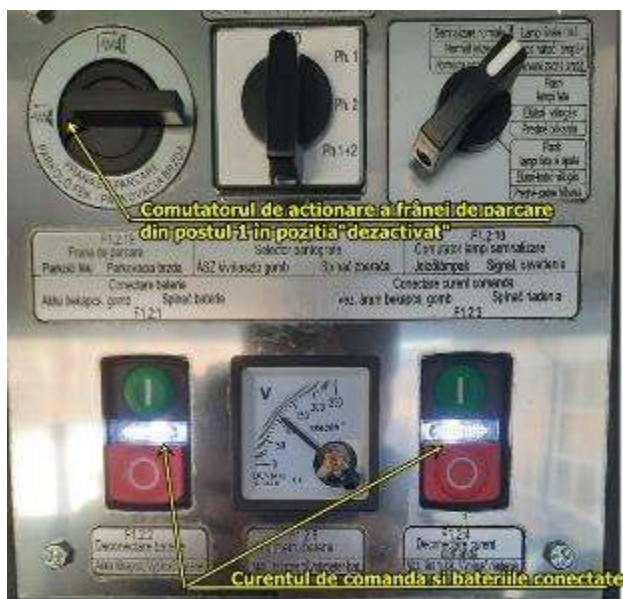
Foto nr.7 Panou comenzi
