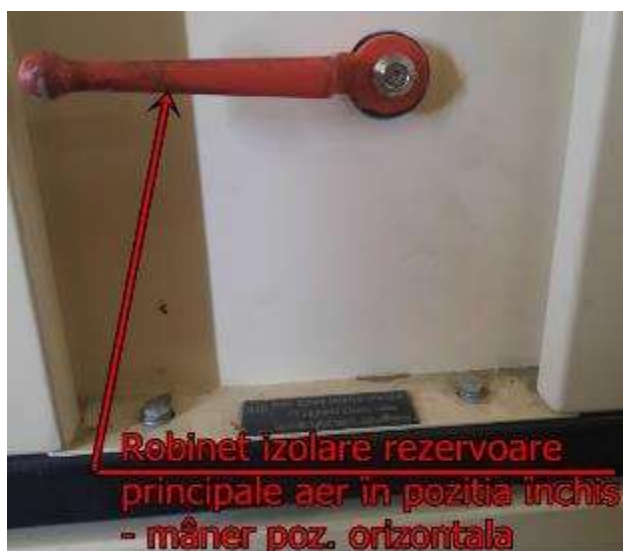
Foto nr.9 Robinet izolare rezervoare principale de aer
