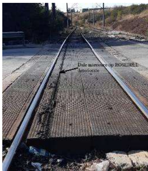
Foto nr.3 dale interioare tip ROSEHILL deteriorate
