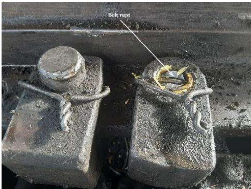
Foto nr.1 Bolțul de la coada de rândunică a schimbătorului de cale nr.66 rupt
