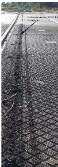
Foto nr.2 dale interioare tip STRAILL deteriorate
