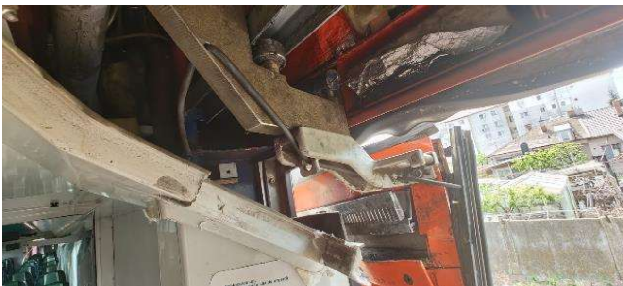
Foto nr.12 Sisteme de susținere și de ghidare deformată la partea superioară a ușii ca urmare a lovirii contragreutății stâlpului
