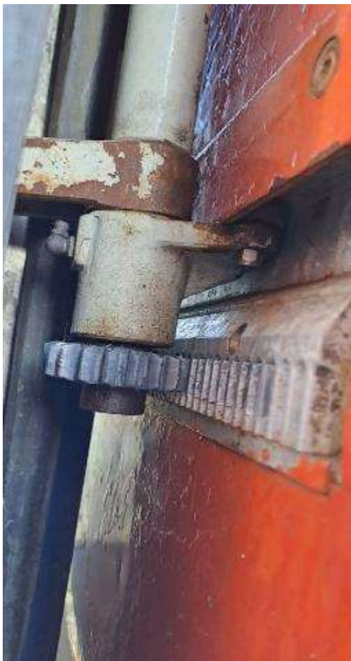
Foto nr.10 Poziția corespunzătoare a barei stabilizatoare pe șina de ghidare la partea inferioară a ușii
