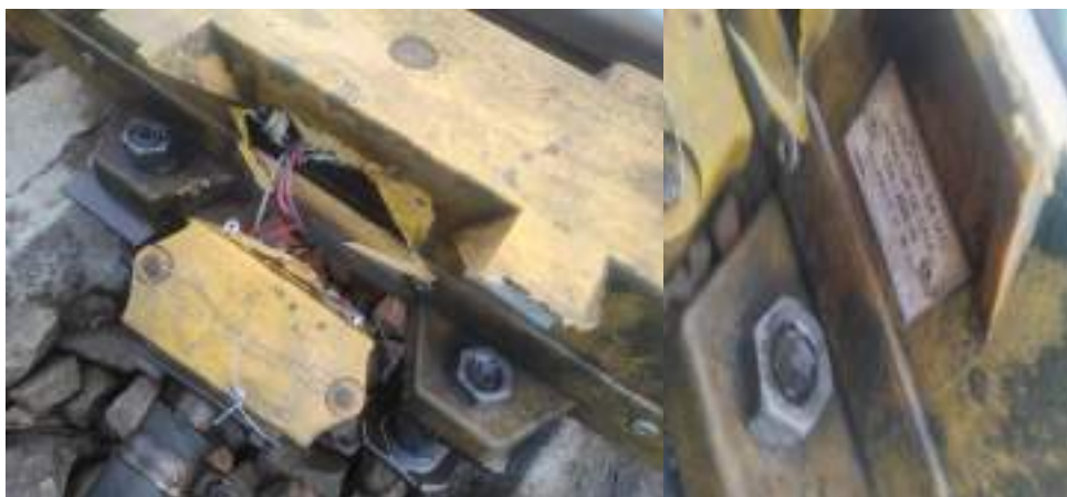
Foto nr.4: Inductor de 1000/2000Hz aferent semnalului prevestitor PrX al stației CFR Găești având seria 345556/03
