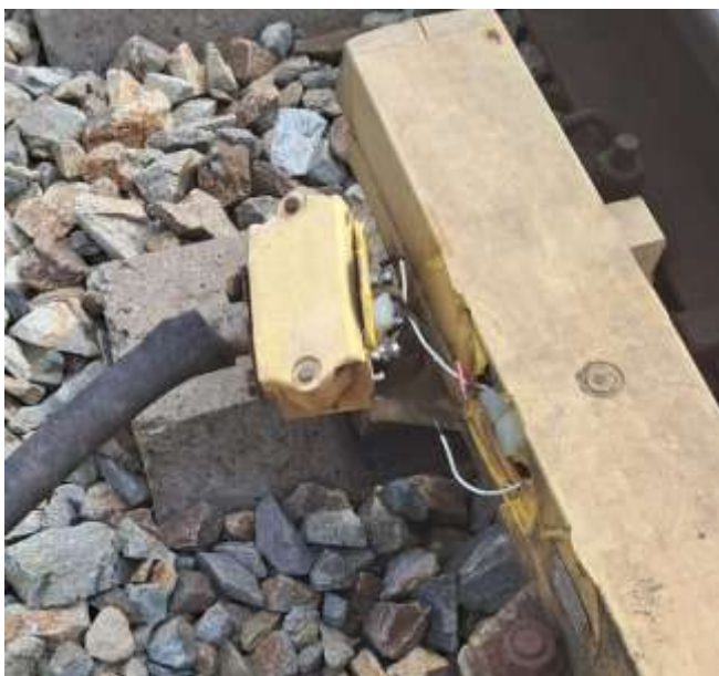
Foto nr.6 Inductor cale semnal luminos PrX halta de mișcare Gălăteni
