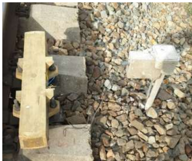
Foto nr.3 Inductor cale semnal luminos BL11 Olteni - Gălăteni
