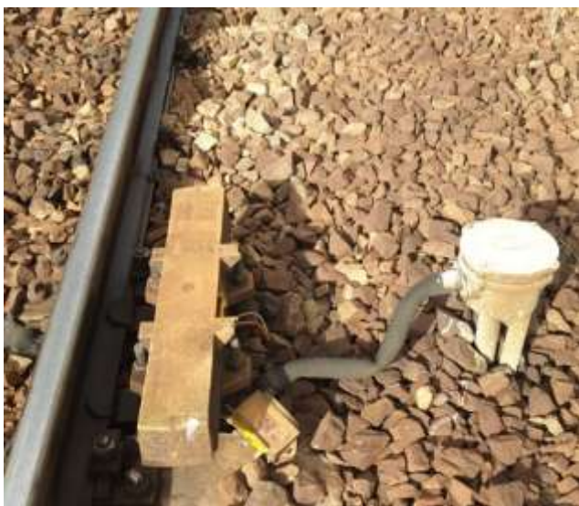
Foto nr.2 Inductor cale semnal luminos PrX stația CFR Olteni
