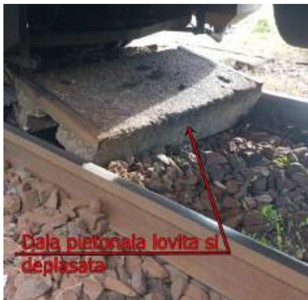
Foto nr.3 Dală pietonală lovită și deplasată acces cap peron linia nr.II
