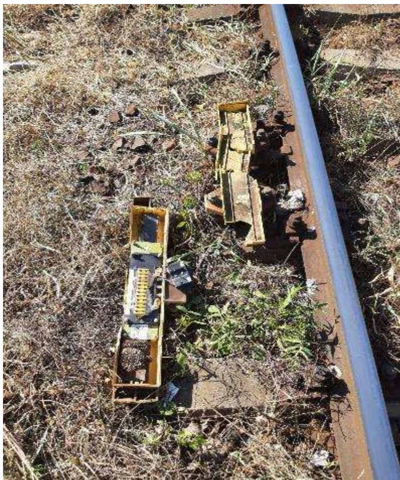
Foto nr.2 : Inductorul de 1000 Hz aferent semnalului de la restricția de viteză lovit
