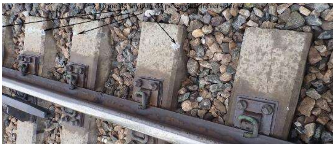
Foto nr.3 Urme de lovire a capătului traverselor
