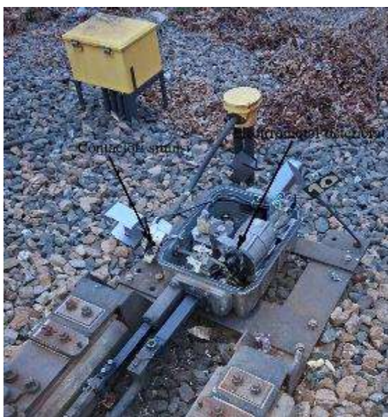
Foto nr.1 Electromecanismul de acționare a schimbătorului de cale nr.10 avariata
