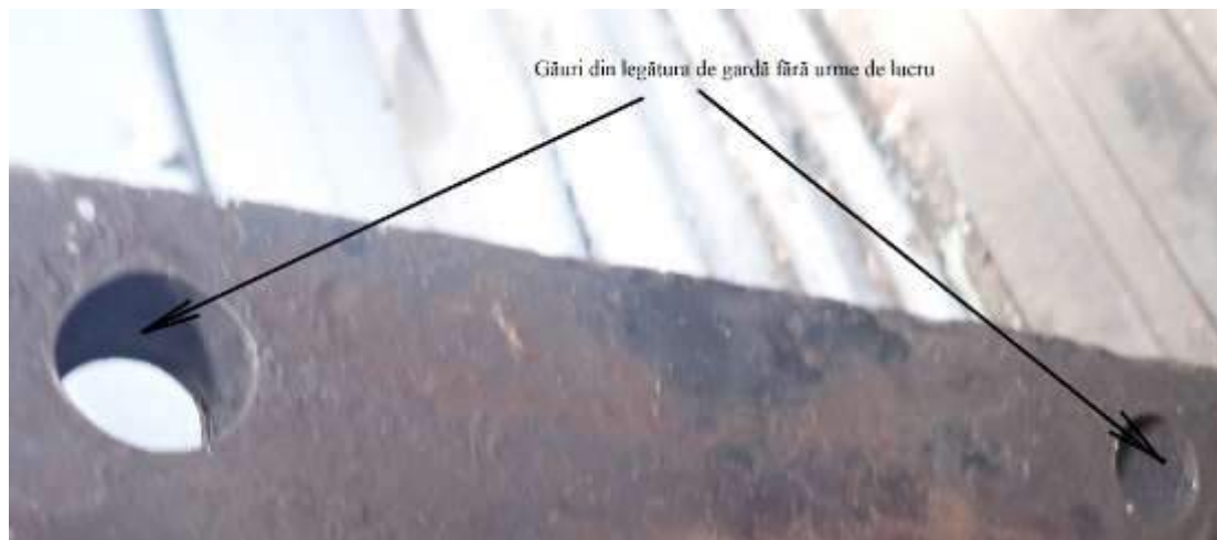
Foto nr.4 Găurile din legătura de gardă, capătul dinspre postul nr.1, fără urme de lucru
