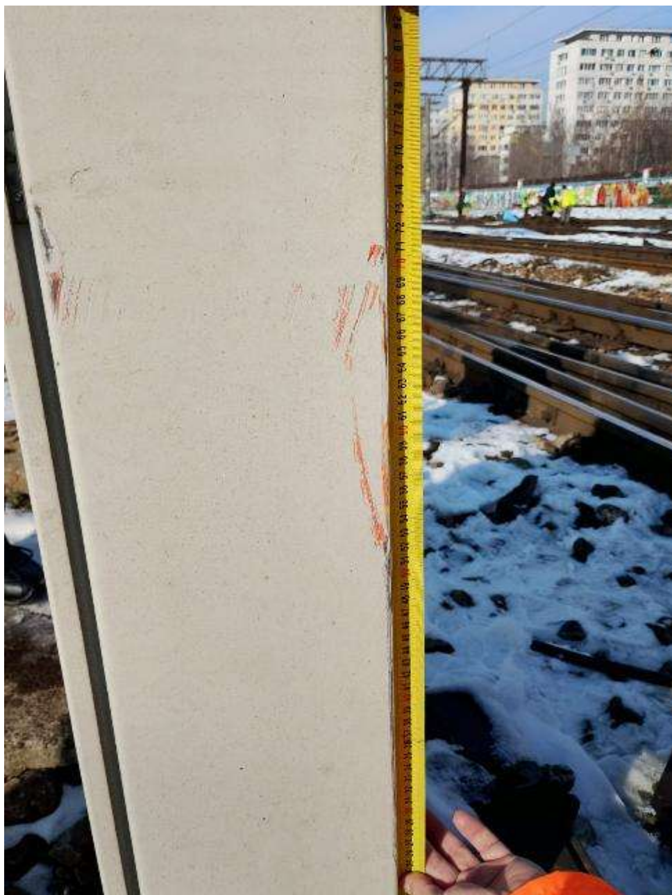
Foto nr.2 : Lovitură în partea laterală a tabloului electric aferent încălzitoarelor de macaz nr.48
