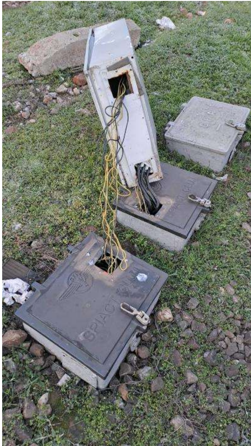
Foto nr.1 : Lovitură în partea laterală a tabloului electric aferent încălzitoarelor de macaz nr.6/8
