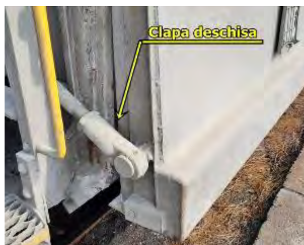
Foto nr.7 Clapă descărcare partea stângă sens mers
