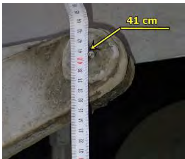
Foto nr.12 Distanța de la centrul axului din capătul levierului până la platforma vagonului partea dreaptă sens mers
