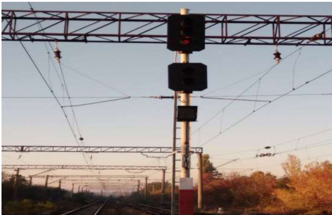
Foto 6: Semnal luminos de ieșire Y IV stația CFR Mogoșoaia
